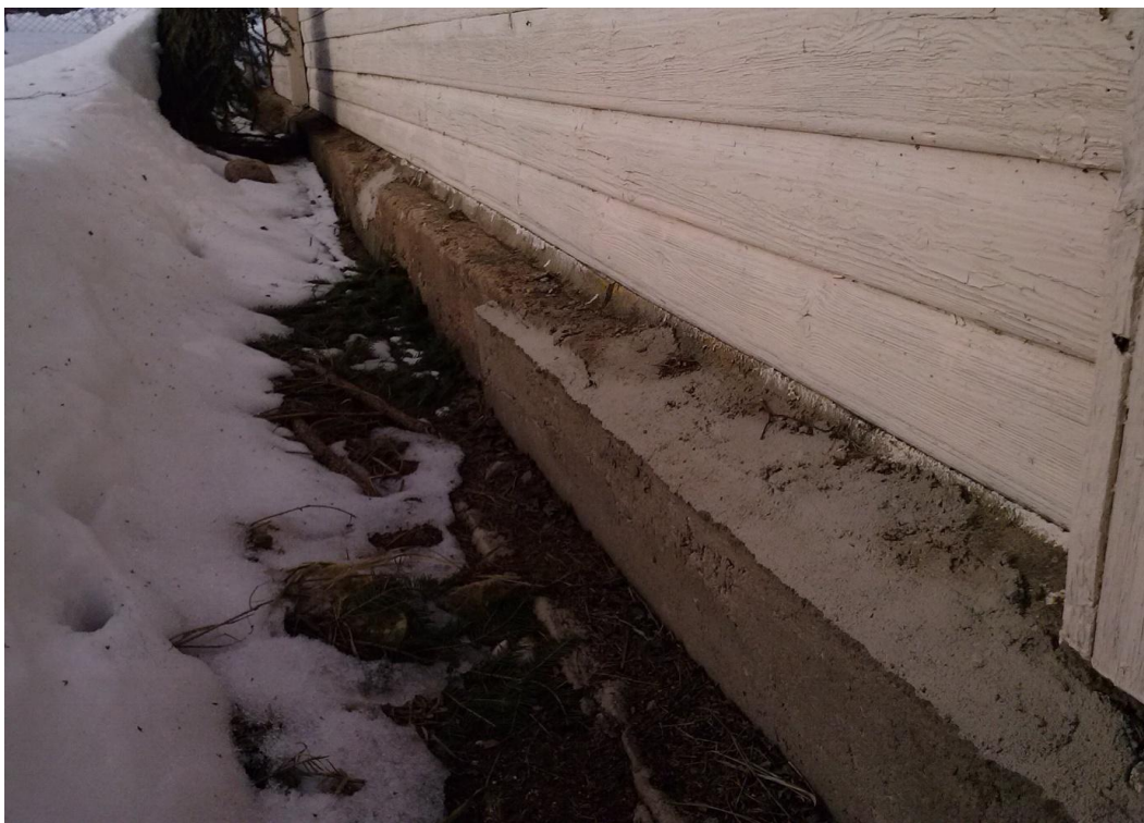
Pilt 2. Sokliosa puudulik katteplekk
