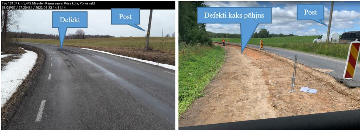
Joonis 3.62 Km 5,442 defektne koht (vasakul) ja joonis 3.63 defektide põhjused (paremal) (Autori erakogu)
