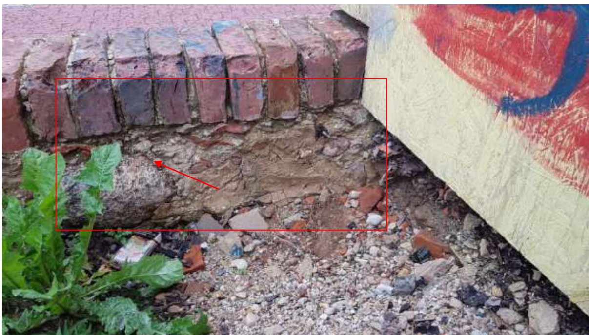
Foto 3.15 – loodenurgast lammutatud hooneosa vundament on ehitatud olemasolevale maakivivundamendile, mis pärineb juba 18.sajandist (joonis 3)
