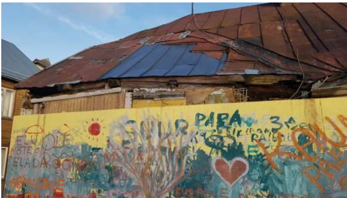
Foto 3.6 – Lammutatud hoonetiiva katuse jälg. (22.01.2020). Sadevesi on pääsenud konstruktsioonidele ligi ning esinevad ulatuslikud kahjustused.
