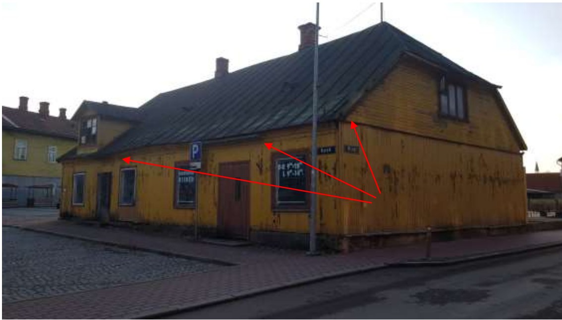
Foto 3.9 – Vaade hoonele kirdest (22.01.2020) 1 - olemasolevad vihmaveerennid on amortiseerunud.
