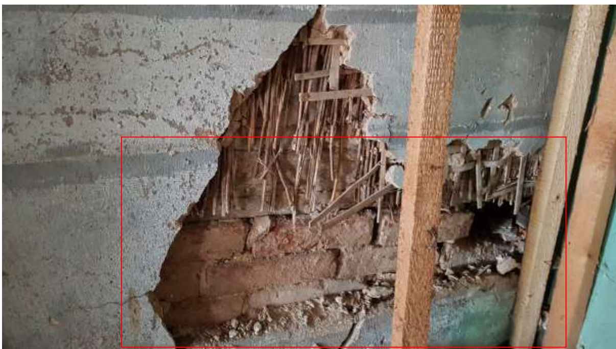
Foto 3.42 – (26.05.20) põikandeseina rõhtpalke on asendatud telliskividega.
