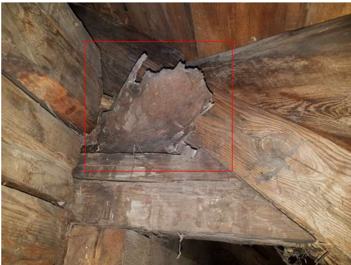
Foto 3.72 – esialgse põhjapoolse otsaseina algupärase katusekelba osa.
