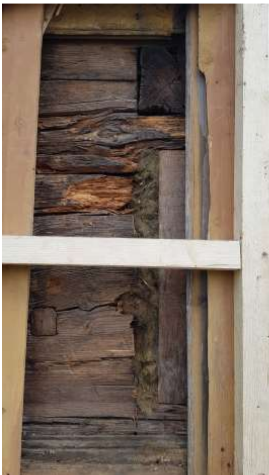
Foto 3.13 – (19.05.20)Hoone edelanurga ülemised kahjustunud palgid tuleb proteesida. Nähtaval tüübelliide (1).
