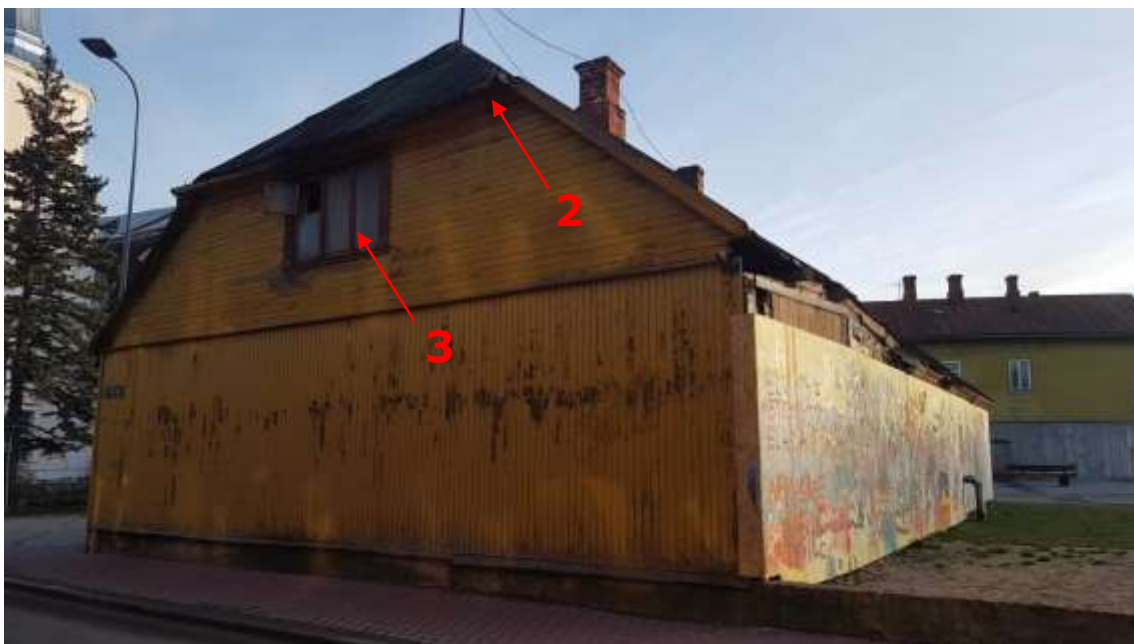
Foto 3.8 – Vaade lõunafassaadile (22.01.2020). 2 – olemasolevad vihmaveerennid on amortiseerunud. 3 – aken katusekorrusel põhjapoolsel viilul pole algupärane
