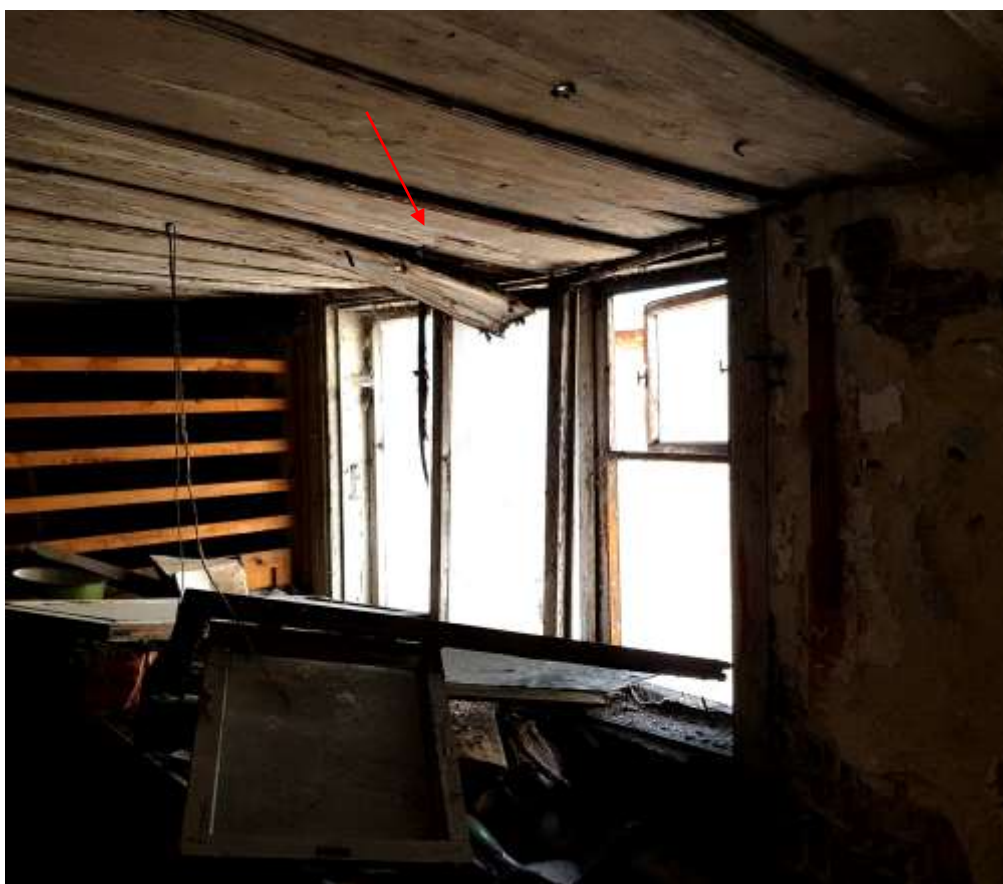
Foto 3.68 - (21.04.20) ruumi 13 põhja sein. Katusekelbas esinevad läbijooksud mis on kahjustanud akent ja laelaudist.
