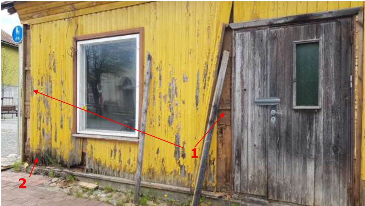
Foto 3.10 – (19.05.2020) 1 – Esifassaadi lõunapoolne nurk on asendatud puitkarkassiga. 2 – puuduliku vihmaveesüsteemi tõttu ning on voodrilaua alumine osa oluliselt kahjustunud, veelaud puudub ning sadevesi kahjustab soklit.
