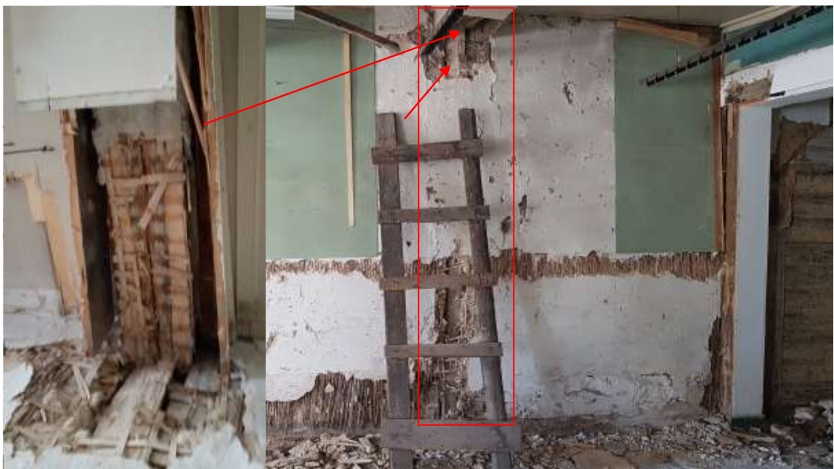
Foto 3.27 – (26.05.20) lammutatud pikikandeseina otsatappide asemele on paigutatud 150x150mm pruss, mida pole rõhtpalkidega fikseeritud. Välisseina on sissevajunud.
