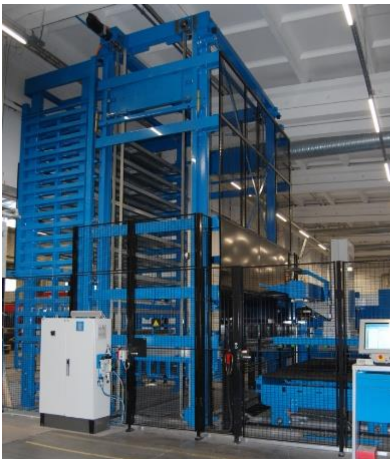
Sele 2.2 PSBB tootmisliini toormaterjali ladu FL ja laadimissüsteem LD1530
