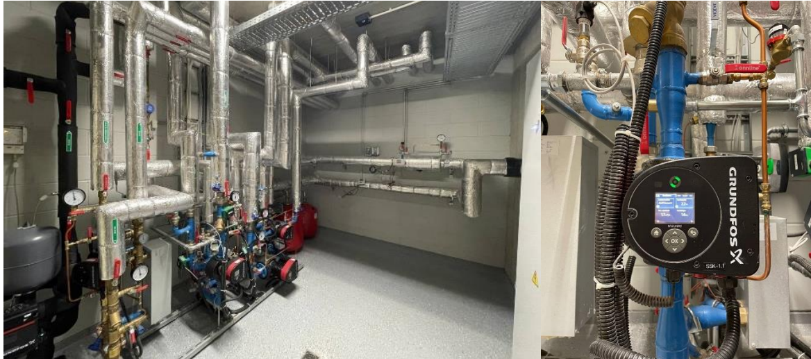
Joonis 2.6. CON õppehoone soojussõlm ning katsete jaoks juhitud ringluspump
