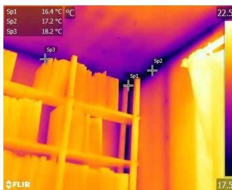
Joonis Nisu 1 Ruuminurgatermograafia
