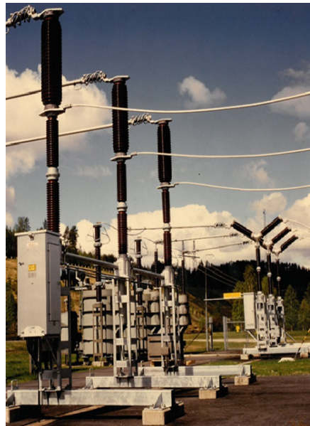
(d) 245 kV 50 kA double/single-break SF 6 gas circuit breakers
