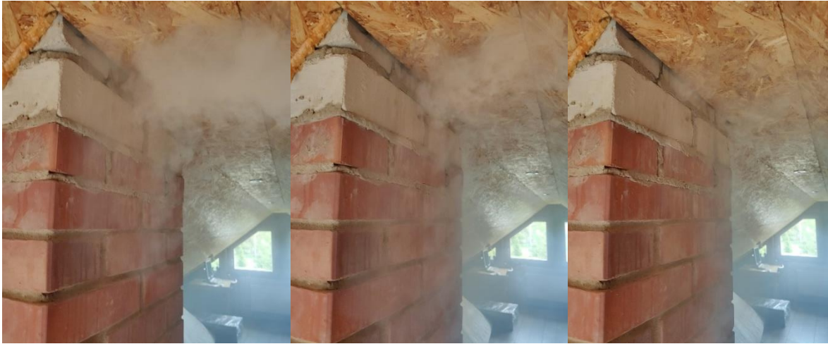
Joonis 1.12 Märkesuitsuga lekkekohtade leidmine – korstna läbiviik katusest
