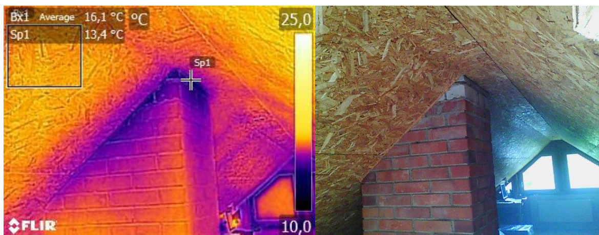
Joonis 1.14 Korstna läbiviigu termopilt
