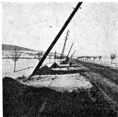
Joon. 8. Viltutõmmatud puustmastid 15 kV elektriliinil Ungaris.
