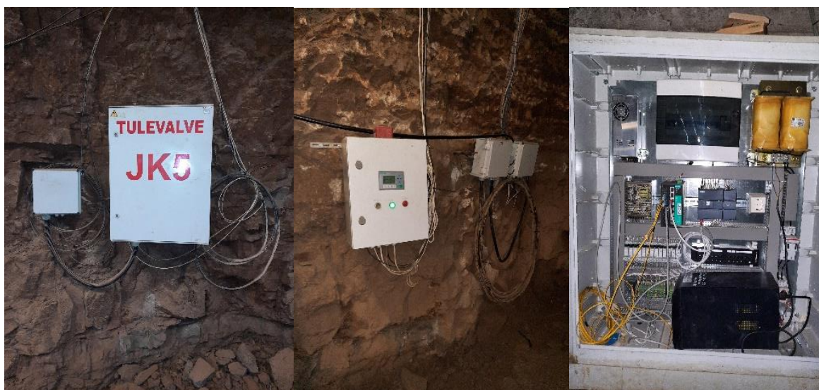
Рисунок 27. Центры пожарной сигнализации (Фото автора)
