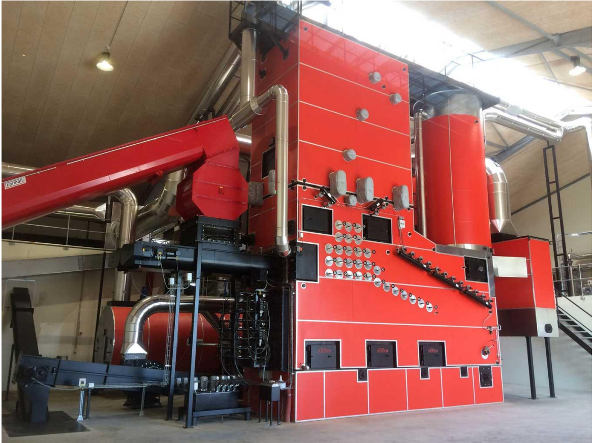
Joonis 1.3 Põhu põletamiseks mõeldud 7 MW Justseni biomassi katel (Justsen Energitechnik, 2021).
