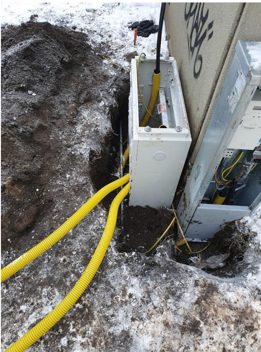
Изображение 3. Подводка питающего кабеля к щиту от подстанции.
