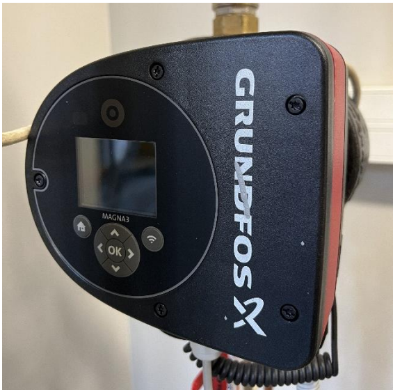
Joonis 6. Tallinna Tehnikaülikooli soojussõlme õppeendi pump Grundfos MAGNA3 25-60, autor 2024
