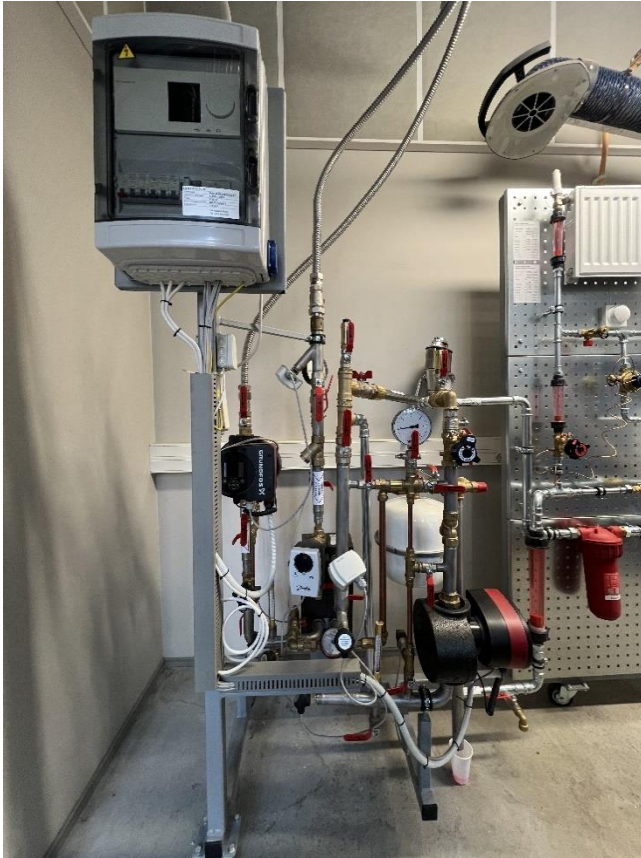
Joonis 2. Tallinna Tehnikaülikooli soojusõlme õppestendi automaatika seadmestik, autor 2024
