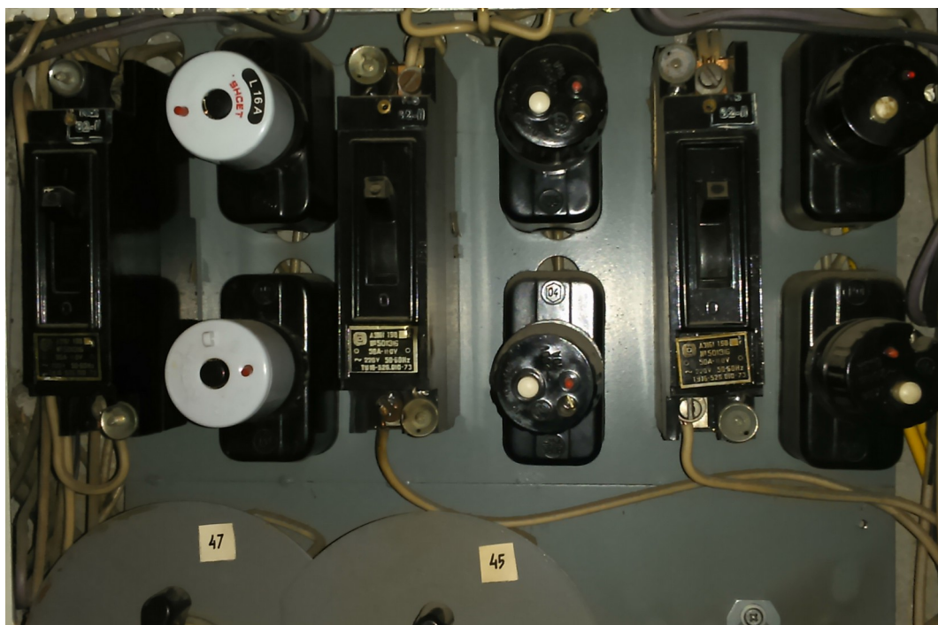
Joonis 4.9: Korrusejaotuskeskuse vaade[6]
