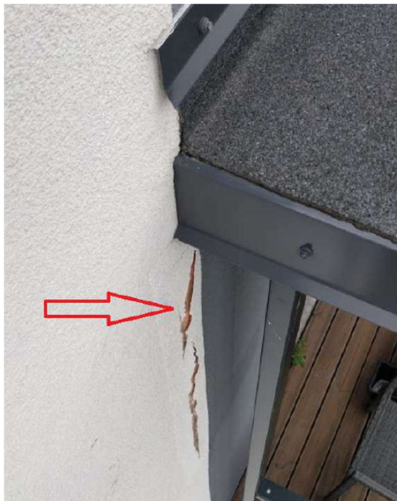
Joonis 3.8: Konsoolse rõdu katuse liite kahjustused.
