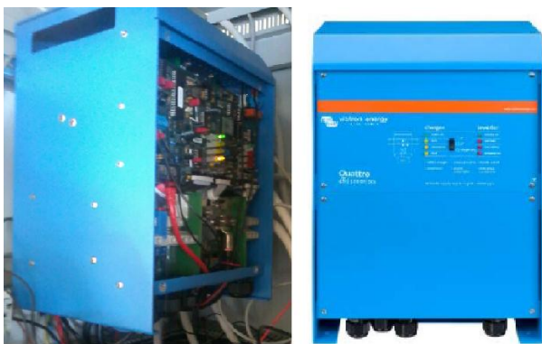
Joonis 2.3. Süsteemis olev inverter Victron energy Quattro
