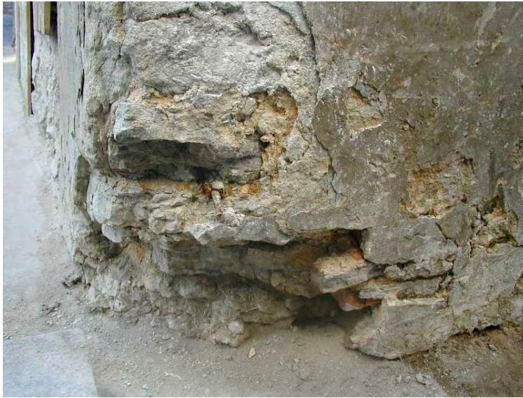
Vesi pritsib vastu soklit, sokkel niiskub ja külmaga müüritist laguneb
