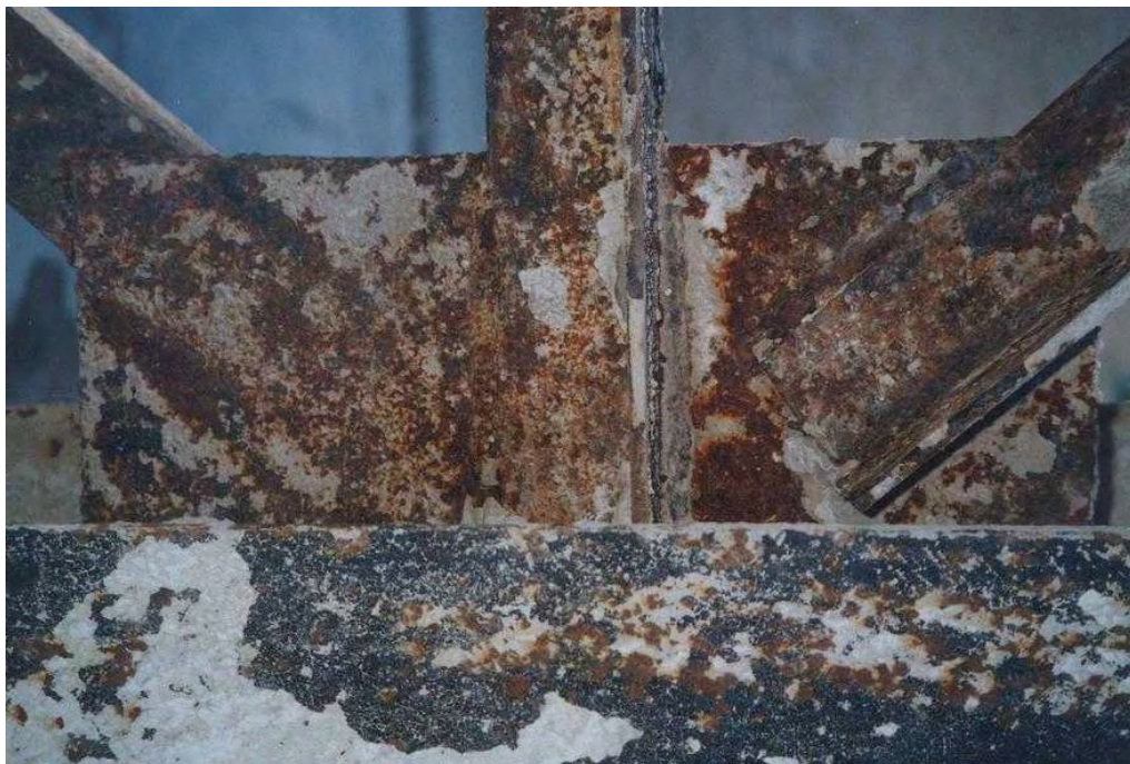
Terassõrestiku elementide korrosioon
