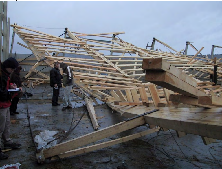
Liimpuit-terassõrestike varing ehitamise ajal sõrestikevaheliste sidemete asendamisel terastrossi ja sõlmedes nõrkade kinniruste tõttu
