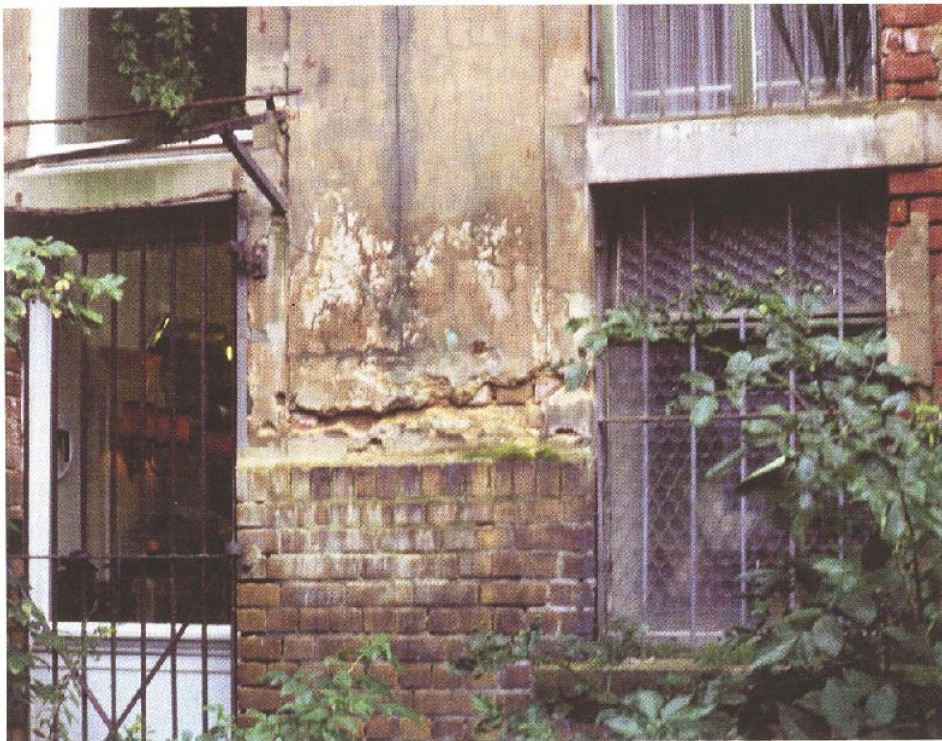
Bild 4.8: Leipzig, Beethovenstr. 10. – Das kapillar eingedrungene Wasser verdunstet oberhalb der Sockelzone, weil der Sockel mit Klinkern außen abgedichtet wurde und läßt infolge dessen Salze an der Erdgeschoss-Wandoberfläche auskristallisieren.
