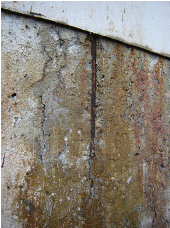
Suurte kahjustustega raudbetoonkorstna välispind
