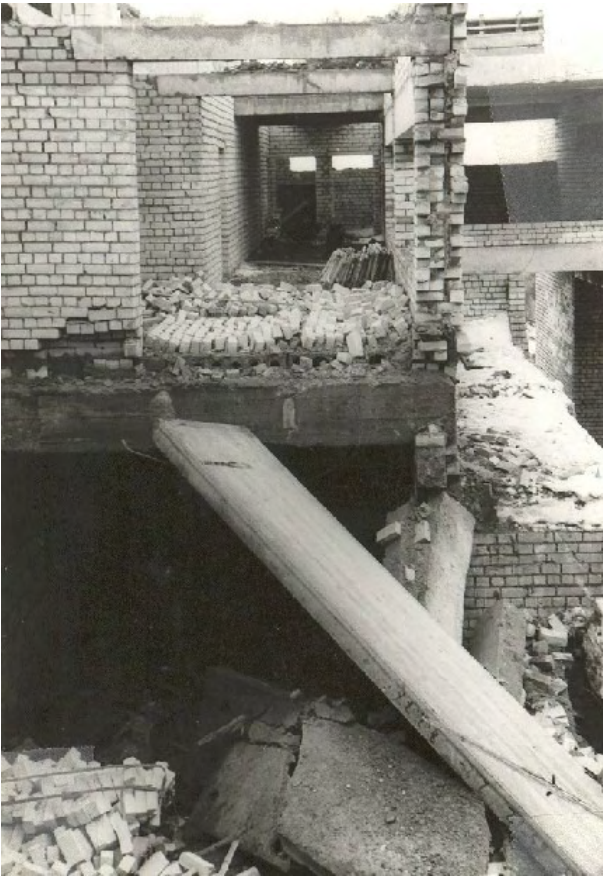
Varing nelja korruse ulatuses ehituse ajal lae materjalidega ülekoormamise tõttu
