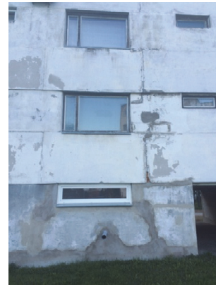
LISA 2, Foto 22. Krohvi ja värvi irdumine fassaadil, Viru 8.
