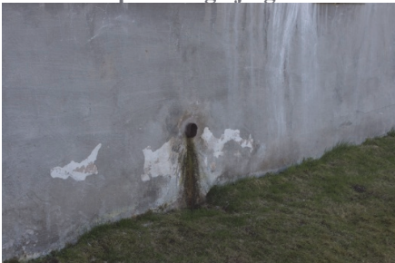
LISA 2, Foto 20. Lagunenud katuse äravoolu toru Viru 4 fassaadil.
