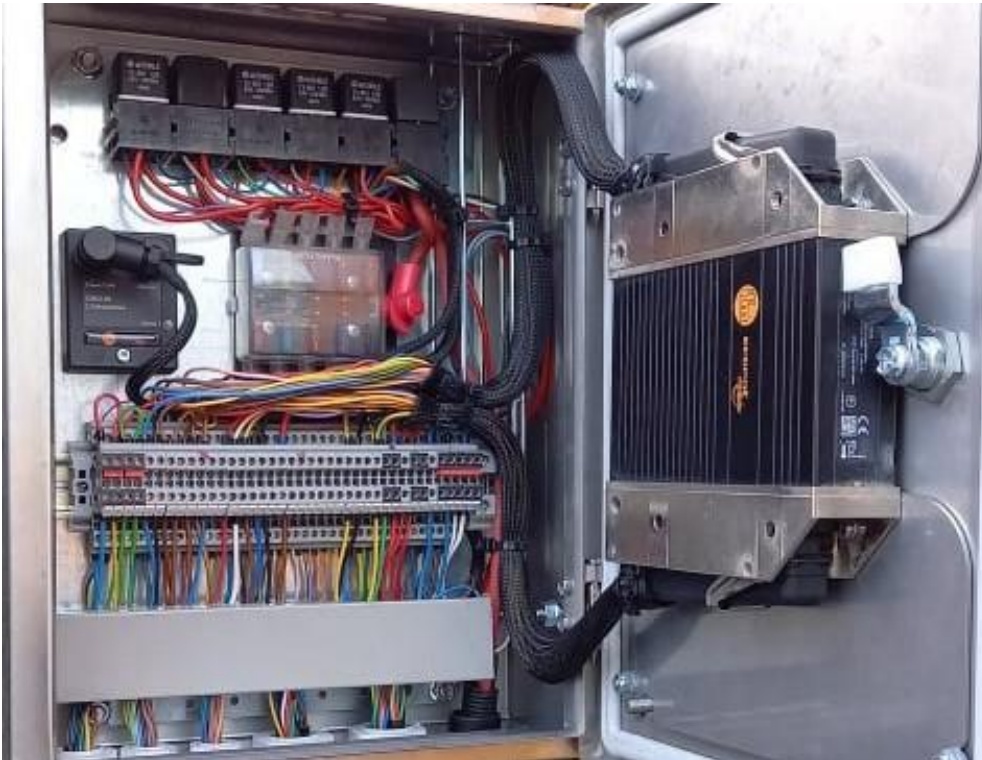
Joonis 4.3. tulemusena valminud elektrikilp.
