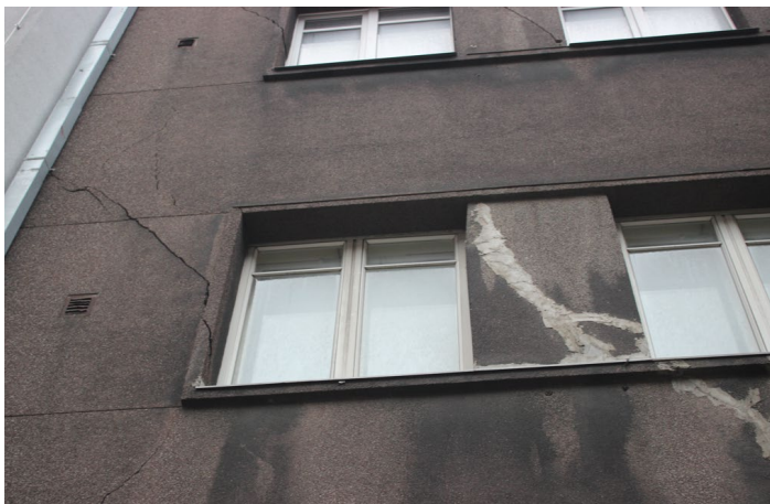
Joonis 19.29. Vajumispraod jm kahjustused hoone fassaadil. Hoonet on mõjutanud hiljem vahetult kõrvale rajatud 9-korruselise hoone ehitus ja lisandunud koormused. Pragude diagonaalne suund näitab, et vasak pool on rohkem vajunud. Allikas: Inseneribüroo REIB OÜ (Mairolt Kakko).
