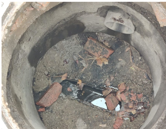
Joonis 5.9. Drenaažikaev, kus sisenev toru on märksa kõrgemal läbivast. Allikas: Inseneribüroo REIB OÜ fotokogu.
