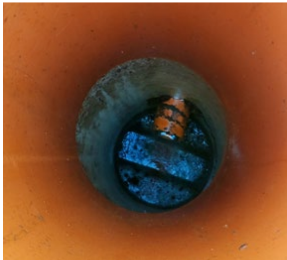
Joonis 5.13. Plastist reoveekanalisatsiooni kaev. Sisenev toru on märksa kõrgemal läbivast. Allikas: Inseneribüroo REIB OÜ fotokogu.
