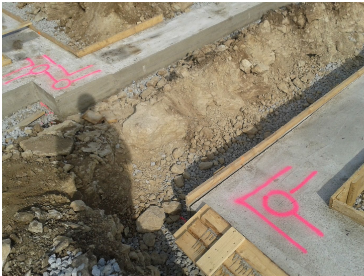
Joonis 6.15. Lintvundamendile hariliku pliiatsiga märgitud müüritise nurgapunktid, mis on omakorda markervärviga esile tõstetud.
