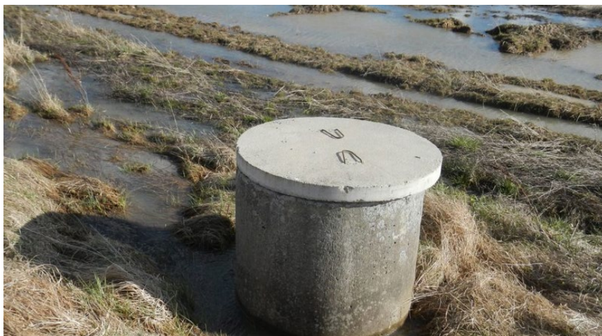
Joonis 5.7. Nõukogudeaegne drenaazisüsteem, selle kaev, vesise ümbruse järgi otsustades on torustik ilmselgelt ummistunud. 22
