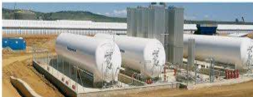
Figure 32. LNG Storage Tanks
