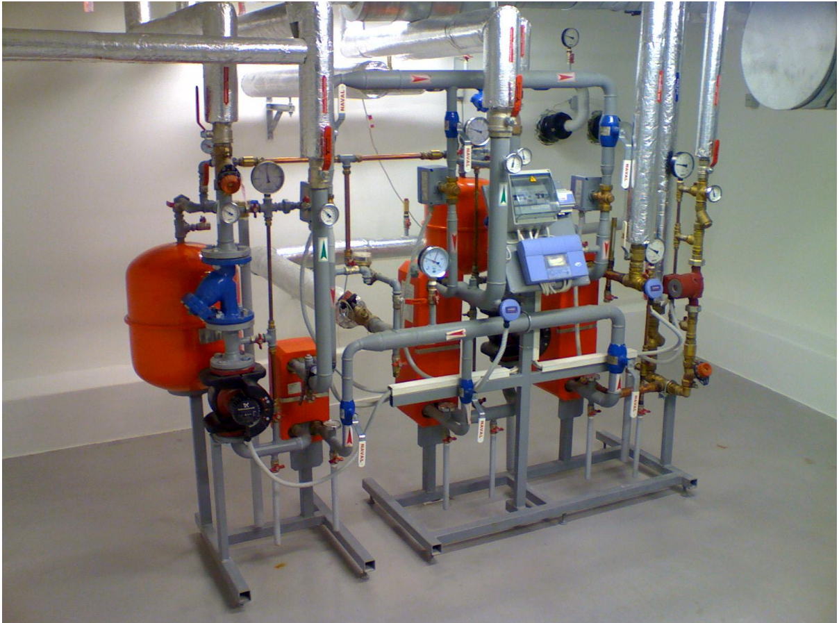
Joonis 3.8. Soojussõlm (allikas: Eesti Termotehnika)
