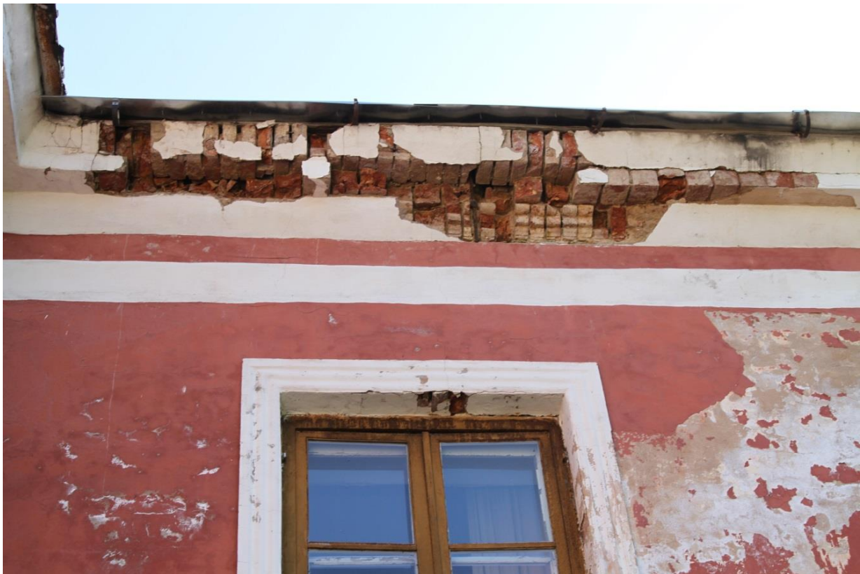
Foto 25. Avariiline karniis hoone tagaküljel. Osa kive on lagunened või välja kukkunud.
