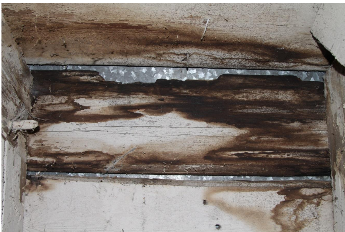
Foto 11. Näide kahjustunud harjalaudisest.
