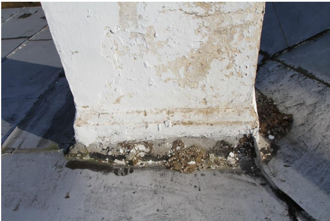
Foto 15. Näide tsementkrohviga tihendatud korstna läbiviigust. Vihmavee ebapiisava suunamise tõttu koguneb korstna ümber prahti.
