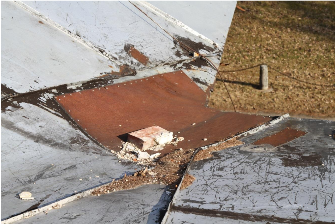
Foto 14. Neelu on lapitud plekiga ning sinna on kinni jäänud korstnakivi ja muu katuselt tulev praht.
