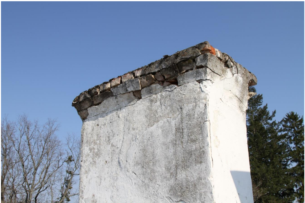
Foto 19. Katteplekita korstnaots. Tagajärgedeks lahtised kivid ja krohvkatte varisemine.
