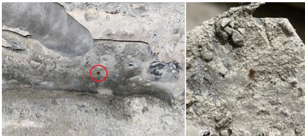
Foto 2.4.2.6: Korrosioonialge katsekeha 3 töövuugiprofiili pinnal (09.11.2024) [autori erakogu]
