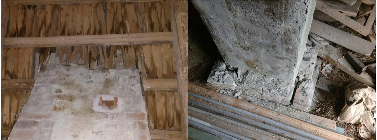
Joonis 21. Lekkiva korstna ja katuse ühenduskoha kahjustused
