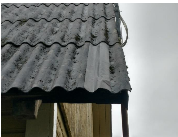
Joonis 17. Bituumenteibiga lapitud auk katuses
