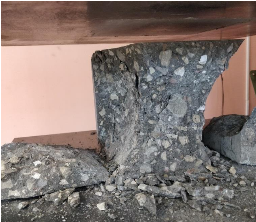
Joonis 4.2 Katsekeha T0-3 (betoon C30/37 XC2 lisandita) purunemispilt
