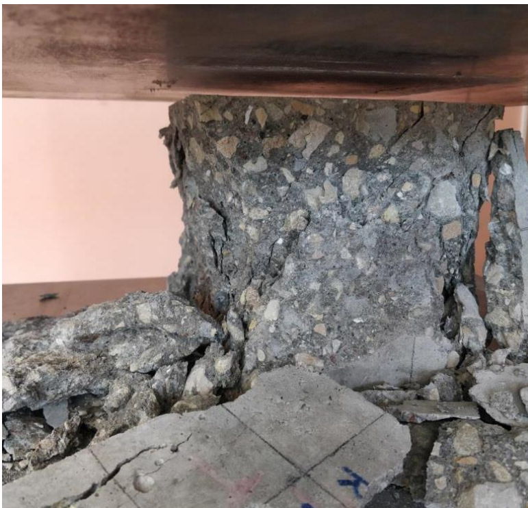
Joonis 4.14 Katsekeha L3-7 (betoon C30/37 XC2 lisandiga) purunemispilt
