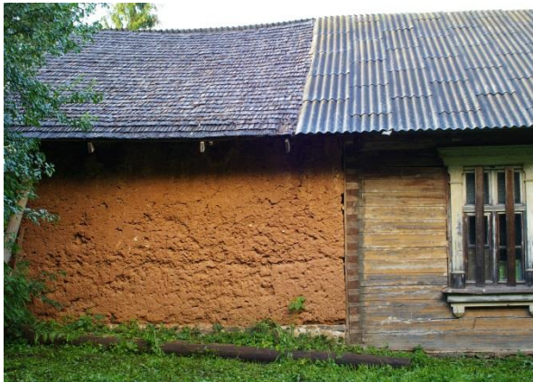
Foto 1.6. Osaliselt eterniidiga kaetud katus hoonelõunaküljel (autori foto)
