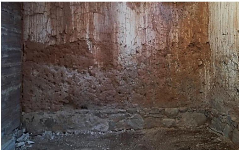
Foto 1.5. Saviseintega aida sisevaade. Seintel nii läbijooksudest, kui ka eksploatatsioonist tingitud kahjustused (autori foto)
