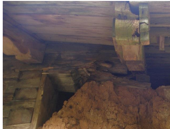
Foto 1.7. Läbijooksust kahjustunud sarikad ning massiivsavisein (autori foto)
