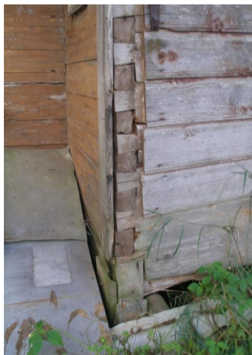
Foto 1.2. Tuulekoja sissevarisenud vundament hoone põhjaküljel (autori foto)
