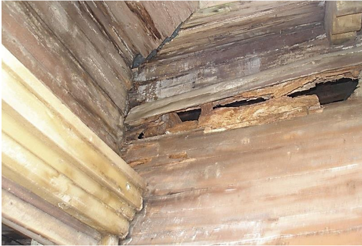
Foto 1.4. Neelukoha läbijooksust põhjustatud mädanikkahjustus tuulekoja ja maja ühendusnurgas hoone põhjaküljel (autori foto)
