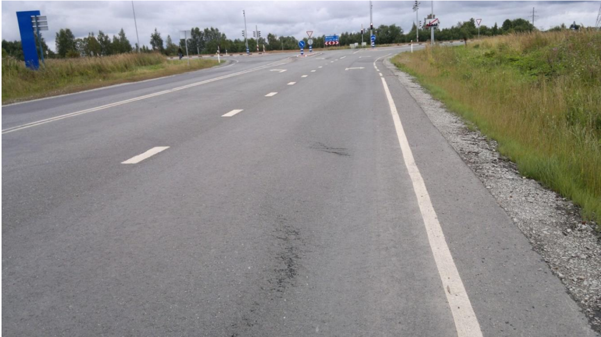
Joonis 1.4. Vana muldkeha ja laienduse kokkupuutekohta tekkinud kattekonstruktsiooni deformatsioon [erakogu]
