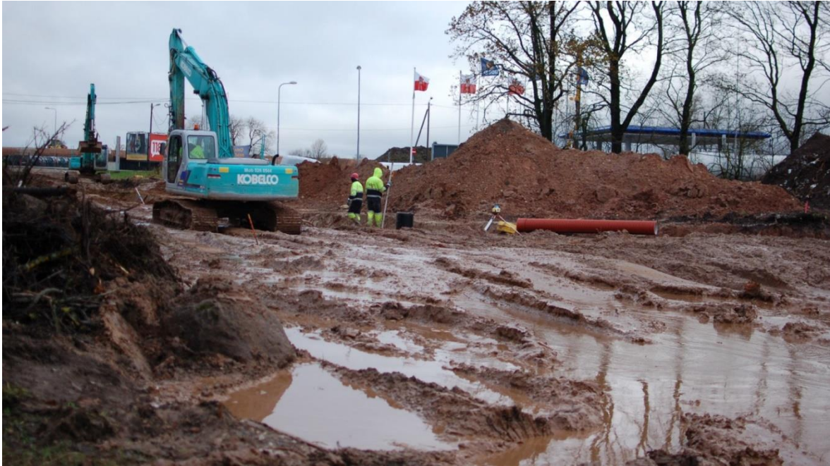
Joonis 1.5. Projektsesse kõrgusesse kaevatud süvendi pealispinna kahjustused, mis on tingitud trassitööde ja ilmastiku koosmõjust [3]
