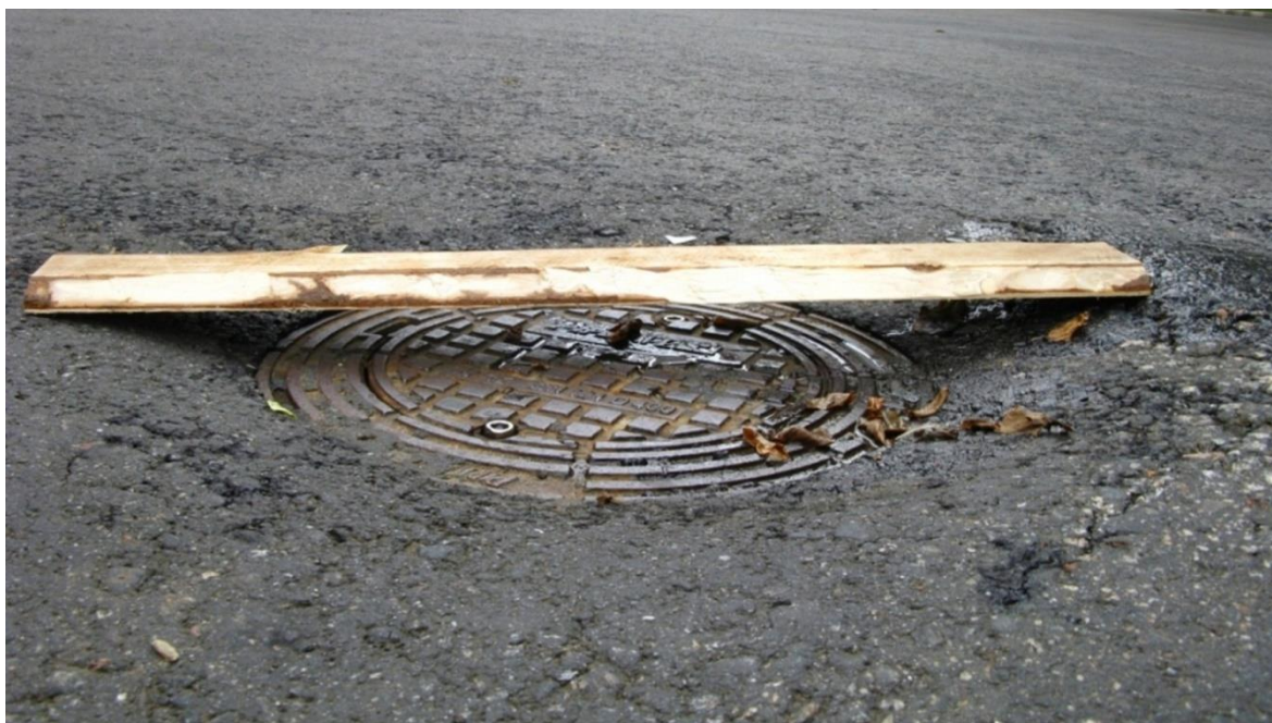
Joonis 4.6. Vahetult peale asfalteerimistöid toimunud vaatluskaevu vajumine [erakogu]
