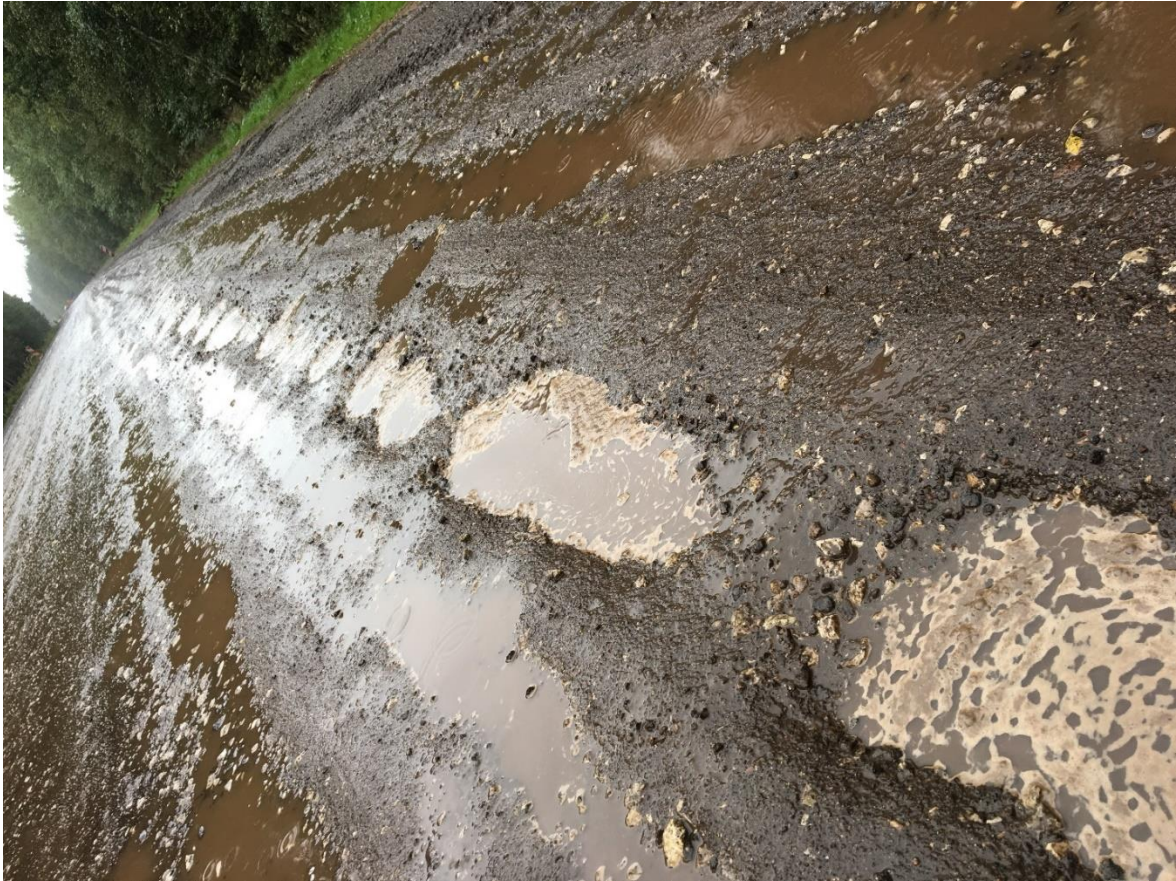
Joonis 3.6. Kompleksstabiliseeritud alus, mille hävitas objekti läbiv liiklus koos nädalapikkuse vihmaperioodiga [erakogu]
