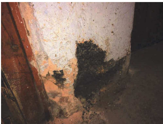
Foto 30 Näriliste poolt tekitatud kahjustused endise külmaruumi isolatsioonimaterjalis ruumis number 041
