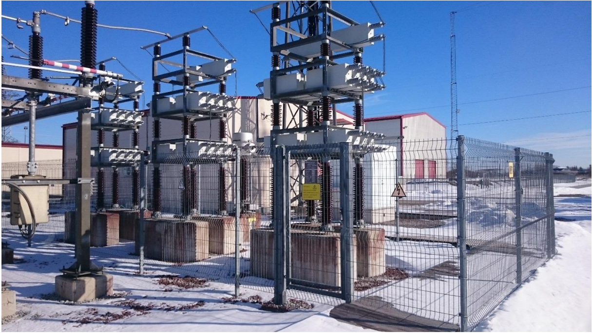
Joonis 1.5 Harku alajaamas kasutusel olev 30 Mvar kondensaatorpatarei
