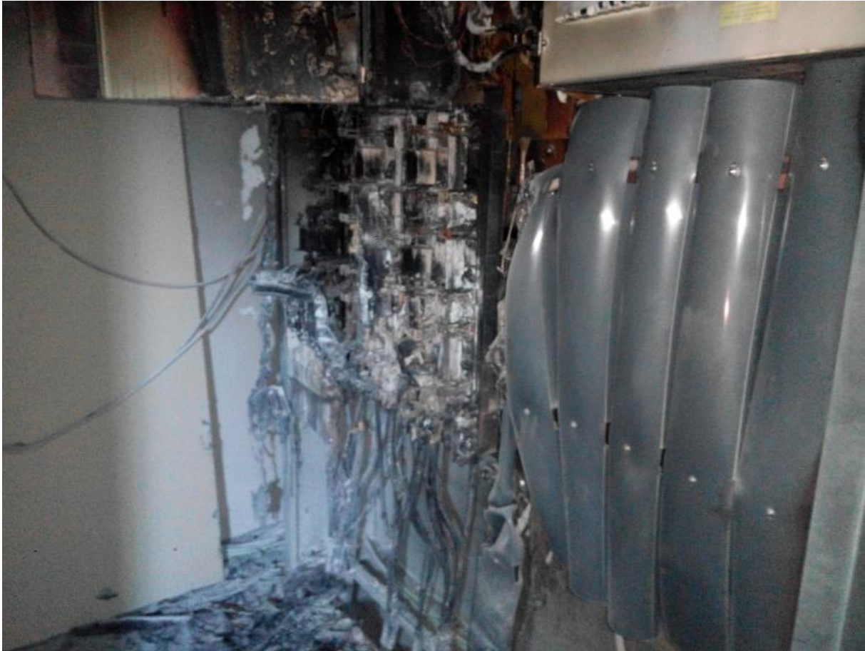
Joonis 5.9 – 431 AJ põlenud 0,4kV jaotusseade
