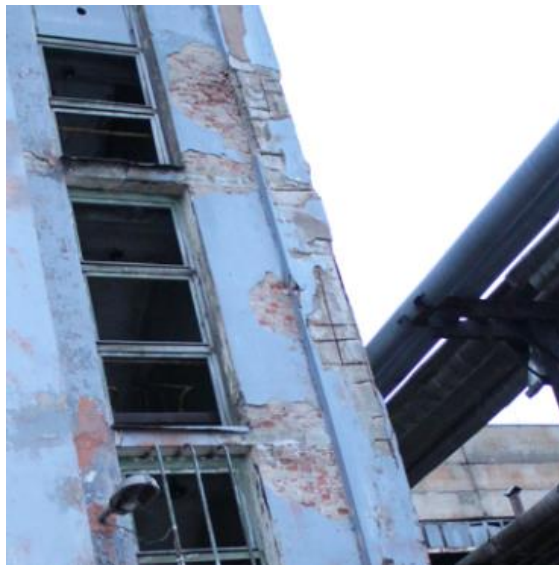
Joonis 5.10 Kahjustunud raudbetoonist post
