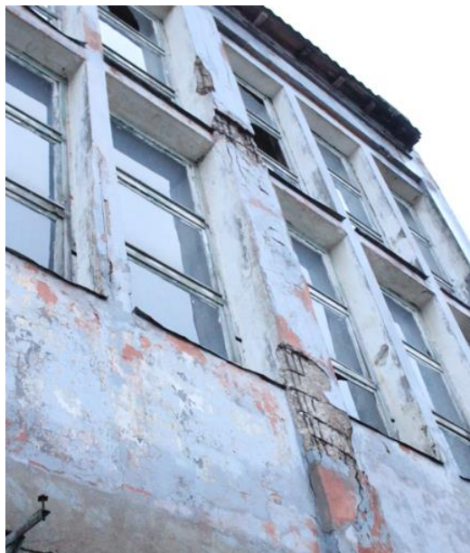
Joonis 5.11 Kahjustunud raudbetoonist post
