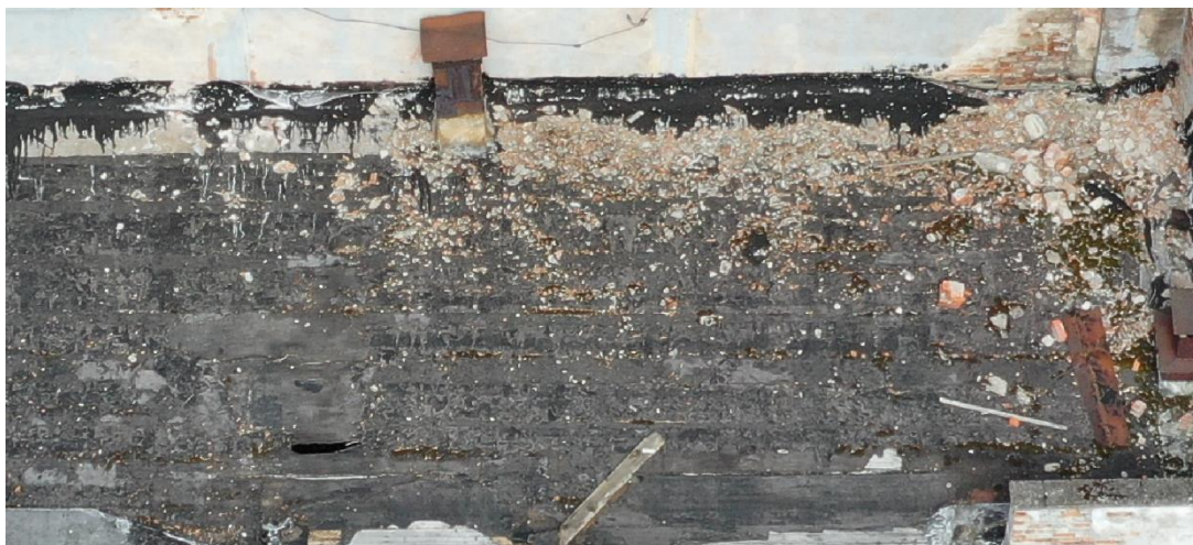
Joonis 5.14 Varisenud tellised katusel
