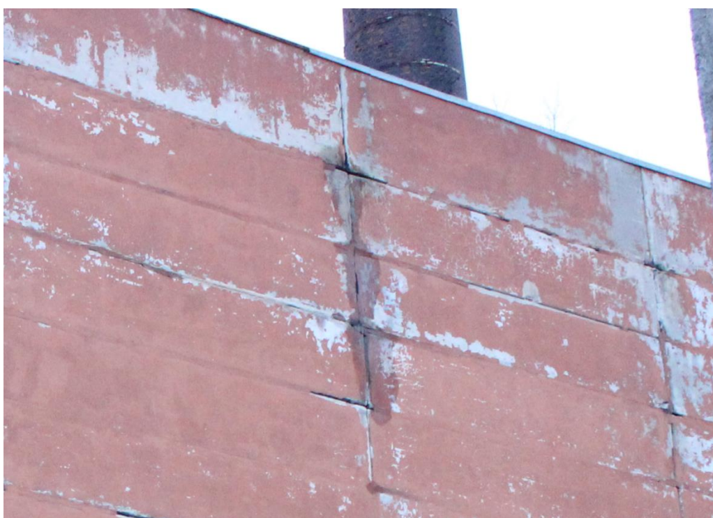
Joonis 5.3 Niiskuskahjustus tuhkpaneelidel
