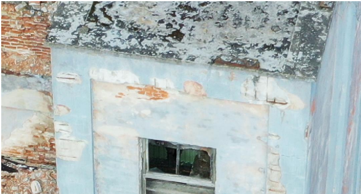
Joonis 5.13 Kahjustunud katuse tala
