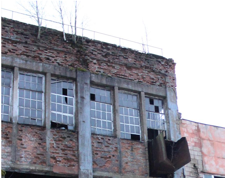
Joonis 5.8 Kahjustunud tellised
