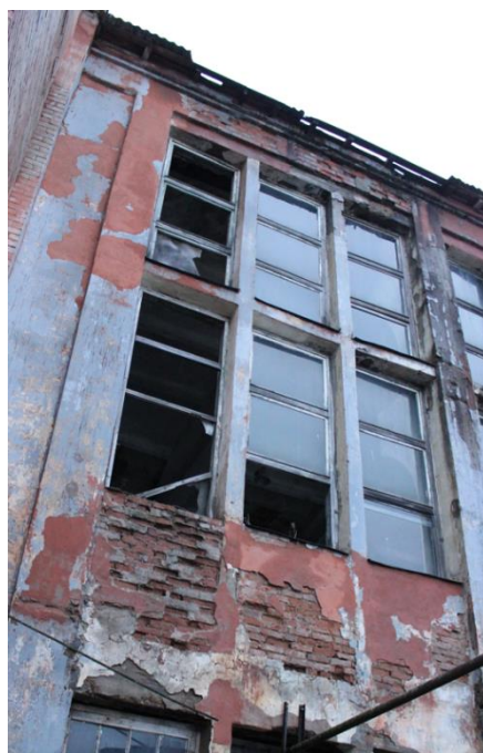
Joonis 5.9 Kahjustunud tellised räästa ja akna all
