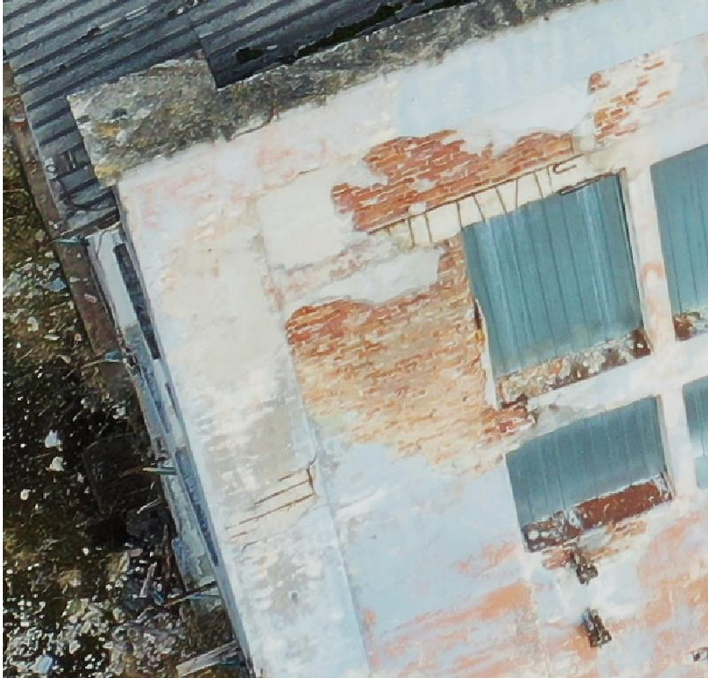
Joonis 5.12 Kahjustunud raudbetoonist akna sillus
