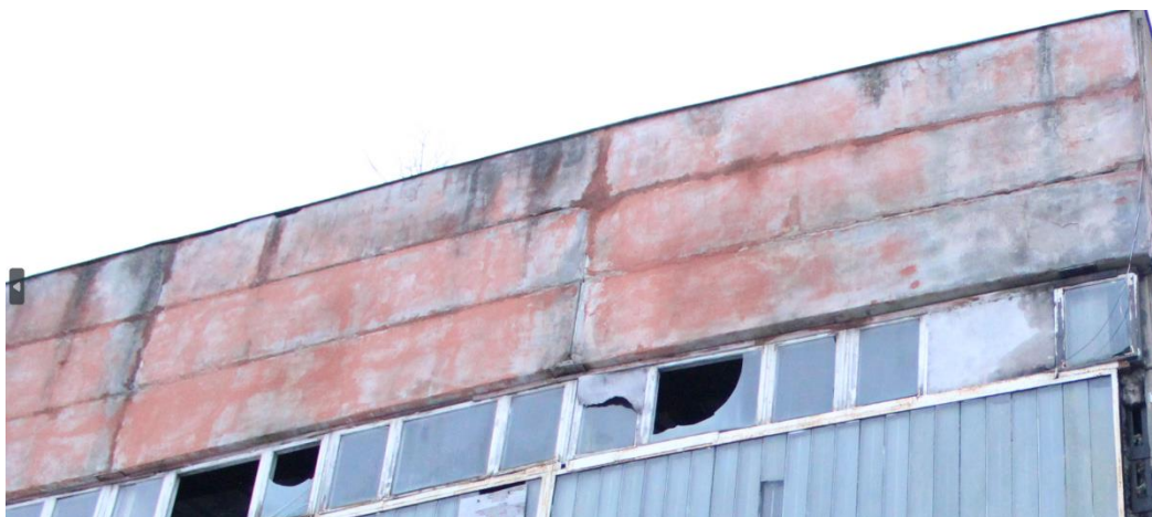
Joonis 5.2 Katuse piiril olevate paneelide niiskuskahjustus
