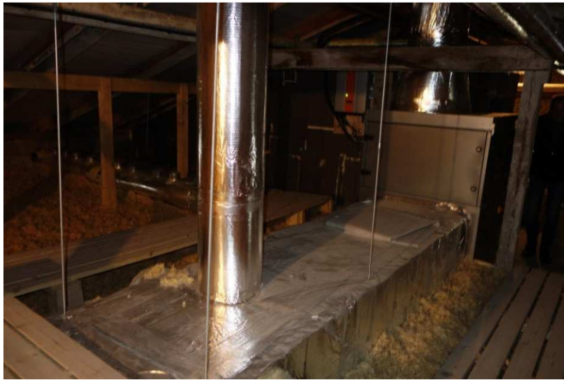
Foto 2.6.1 Pilpit soojustagastussüsteemi soojusvaheti katusel
