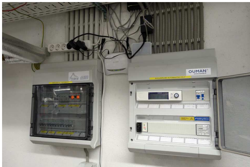
Foto 2.6.3 Soojussõlme elektrikilp (vasakpool) ja soojussõlme automaatikakilp (parempool)
