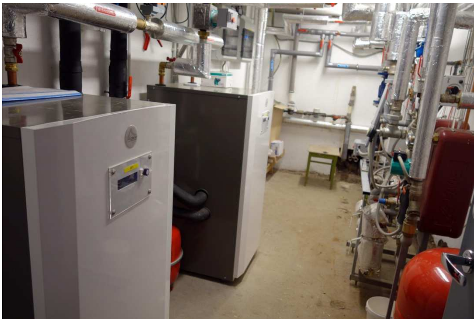
Foto 2.6.2 Profener'i poolt pakutavad soojuspumbad
