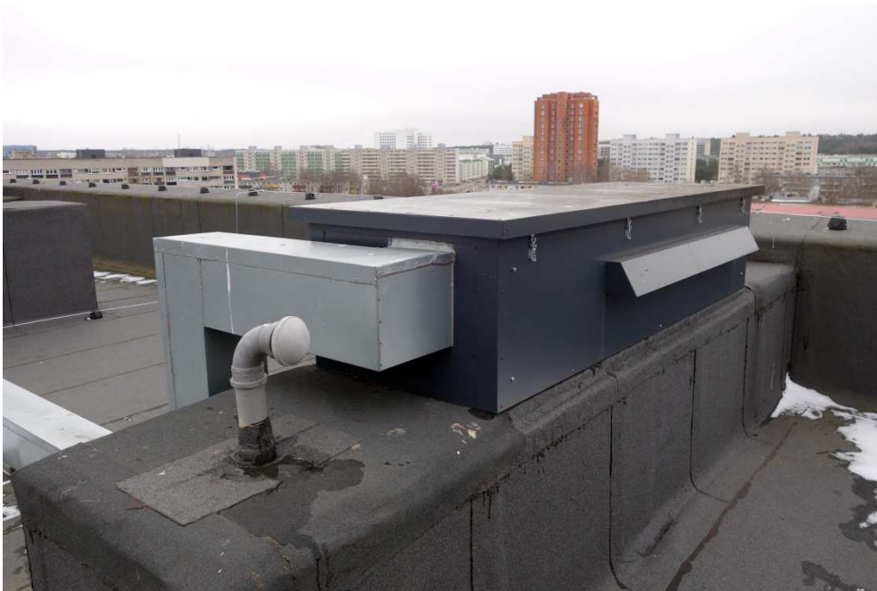
Foto 2.6.4 Heatcatcher'i soojustagastussüsteemi soojusvaheti katusel
