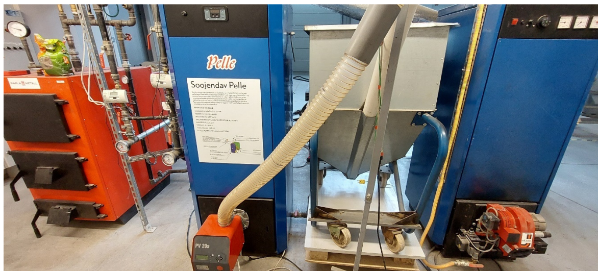
Joonis 2.1.3 Katseobjektid (vasakult) LUK-35, STI20VTP-Pelle kütusemahutiga ja STI20-Malle Tallinna Tehnikaülikooli Energiatehnoloogia Instituudi katsehallis
