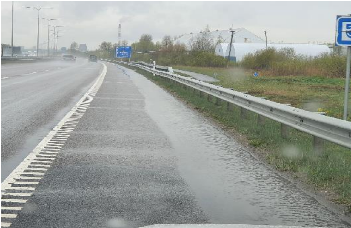
Joonis 3.20 Kõrgema peenra põhjustatud vee kogunemine
