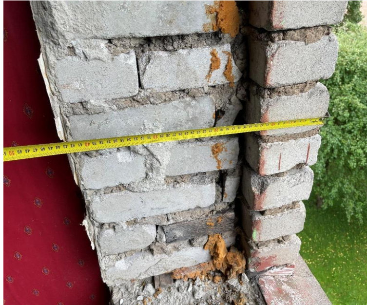
Joonis 3.2 Foto välisseina demonteeritud avatäite kohast [31]
