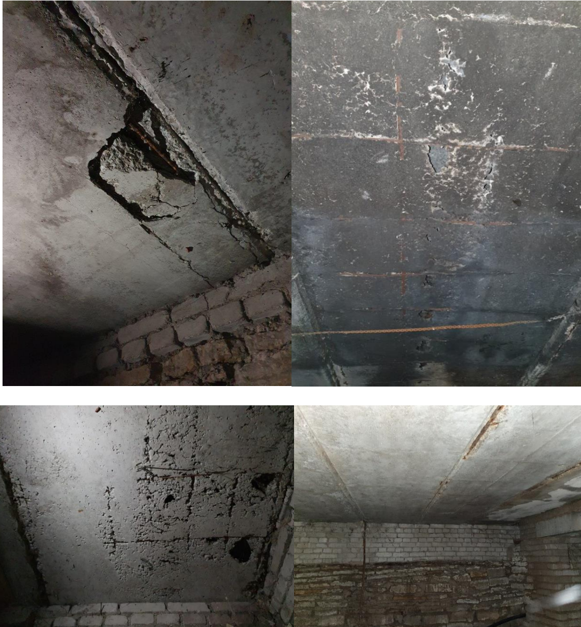
Joonis 4.6 Fotod keldrikorruse laes asuvatest raudbetoonist õõnespaneelidest ja nende altpoolt visuaalselt eristatavatest kahjustustest, mille alusel õõnespaneele korduskasutada ei saa. (Fotod: M. Kiviste).
