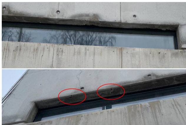
Joonis 4.10 Avauste ümbruste veekahjustused ja armatuuri roostetamine [autori foto]
