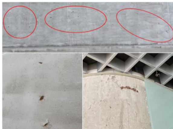
Joonis 4.34 Armatuuri korrosiooninähtused ida-, põhja- ja lõunafassaadil [autori foto]
