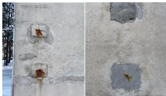
Joonis 4.33 Armatuuri korrosioon treptorni lõuna- ja põhjaküljel [autori foto]
