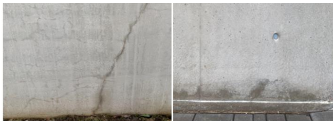
Joonis 4.16 Veekahjustused soklipiirkonnas lääne- ja idaküljel [autori foto]
