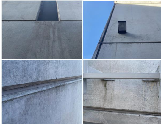
Joonis 4.25 Bioloogilise kasvu ilmingud fassaadipiirkonnas [autori foto]
