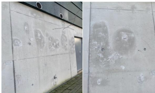
Joonis 4.32 Külmakahjustused fassaadipinna lääneküljel [autori foto]
