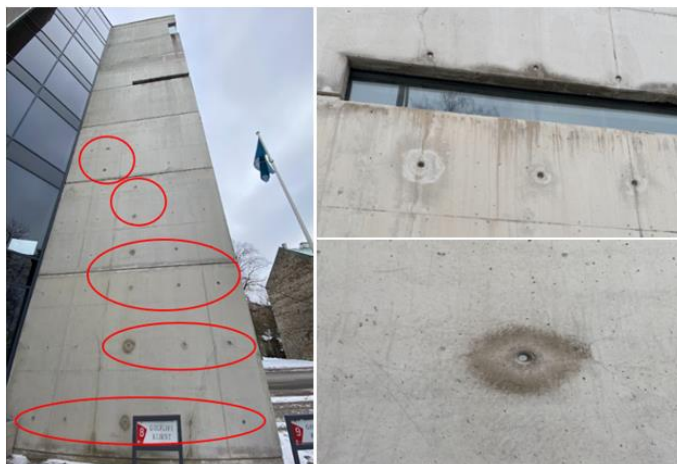
Joonis 4.11 Tõmbiaukade ümbruste veekahjustused lääne- ja lõunasuunal [autori foto]
