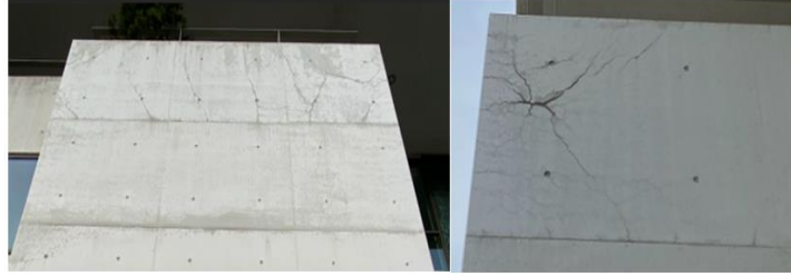
Joonis 4.18 Pragunemine lõunaküljel fassaadi ülaosas [autori foto]
