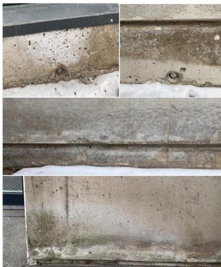
Joonis 4.6 Soklipiirkonna soolakahjustused [autori foto]
