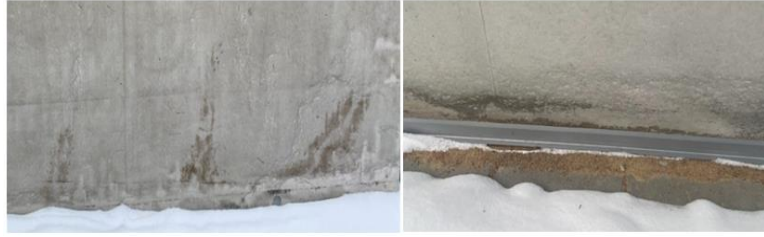
Joonis 4.31 Soklijoone veekahjustused põhja- ja idasuunas [autori foto]
