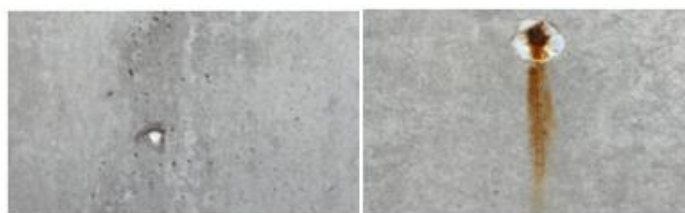
Joonis 4.51 Betooni delaminatsioon ja armatuuri korrosioon lõunaküljel [autori foto]
