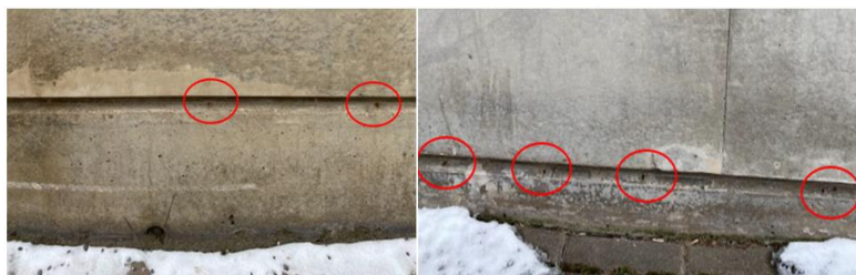
Joonis 4.8 Armatuuri korrosioon lääne ja idaküljel [autori foto]
