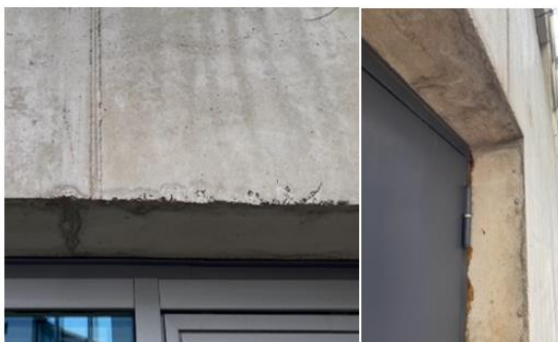
Joonis 4.43 Kärjeline betoonipind avauste ümber [autori foto]
