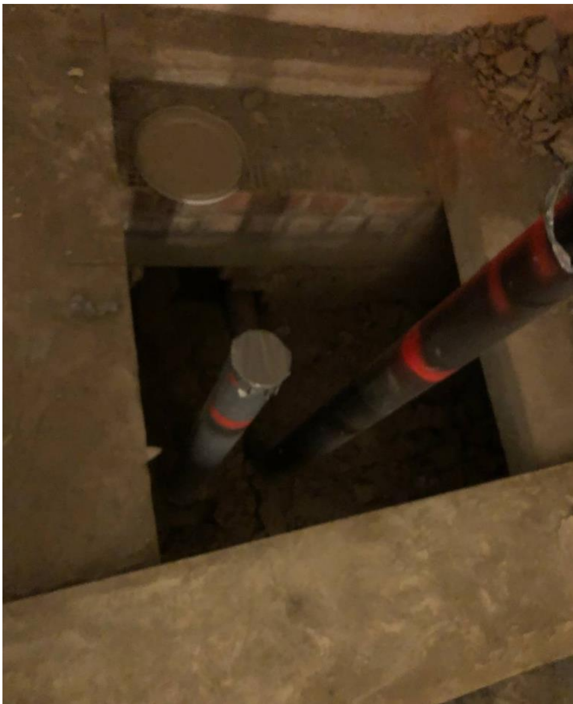
Lisa 6 Sademevee- ja olmekanaliseerimise puhastusotsad pörandas tehnilises kanalis [Autori foto]
