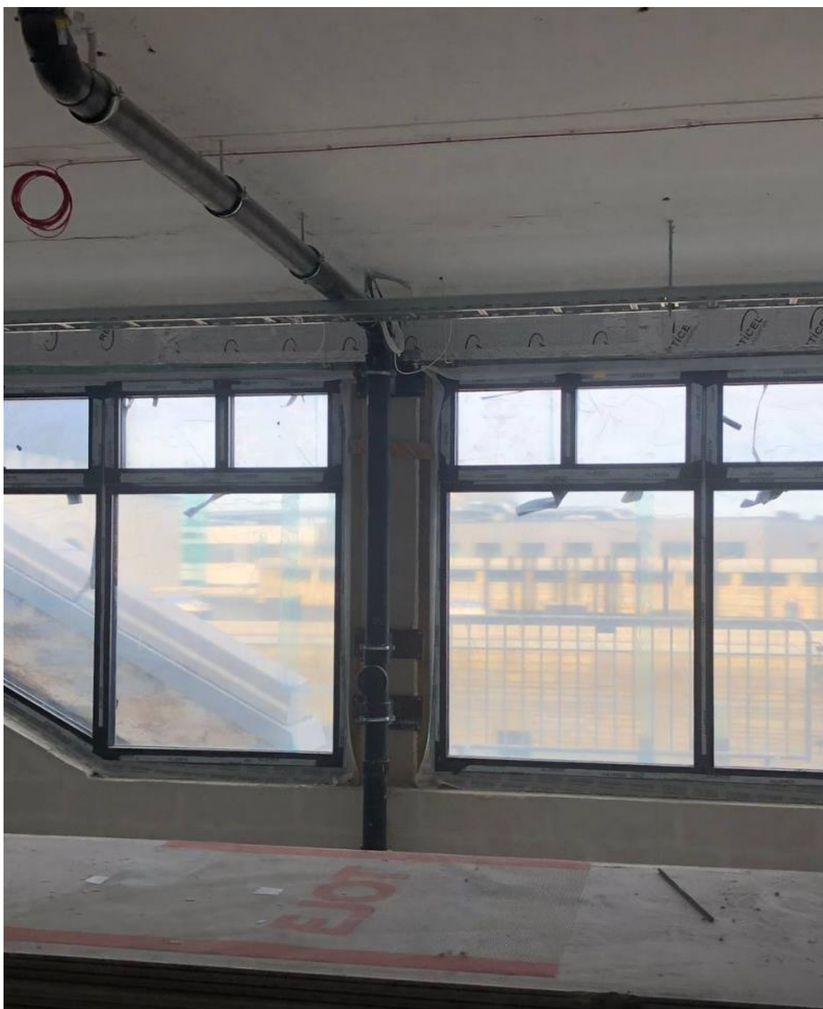
Lisa 3 Trepikujulise katuse sademeveetorustik akende vahel posti kohal [Autori foto]
