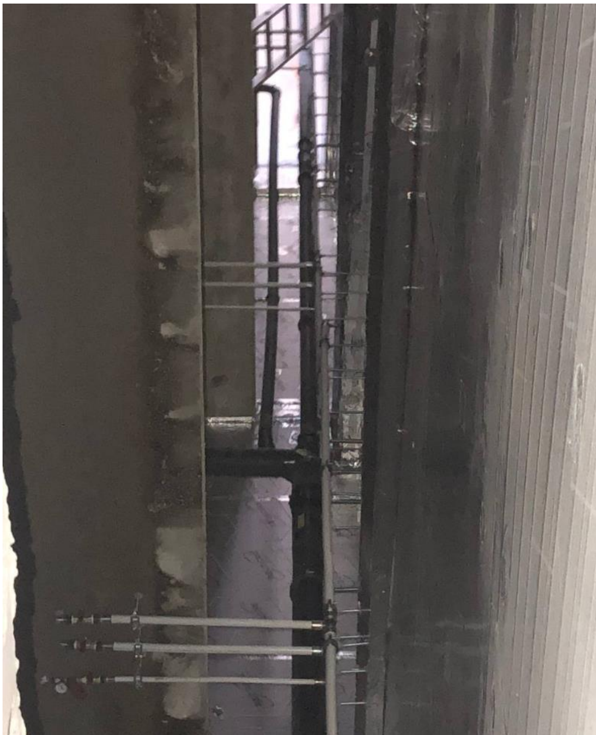
Lisa 10 Sademevee Geberit Pluvia vaakumtorustik (vasakpoolne toru) šahtis [Autori foto]
