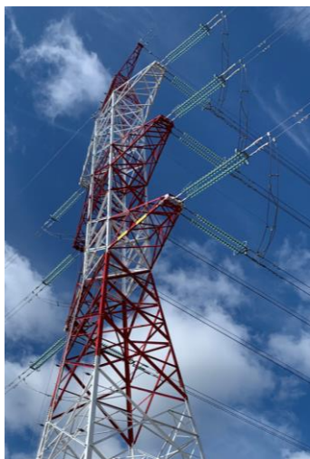
Joonis 2.3 330 kV hargnemismast
