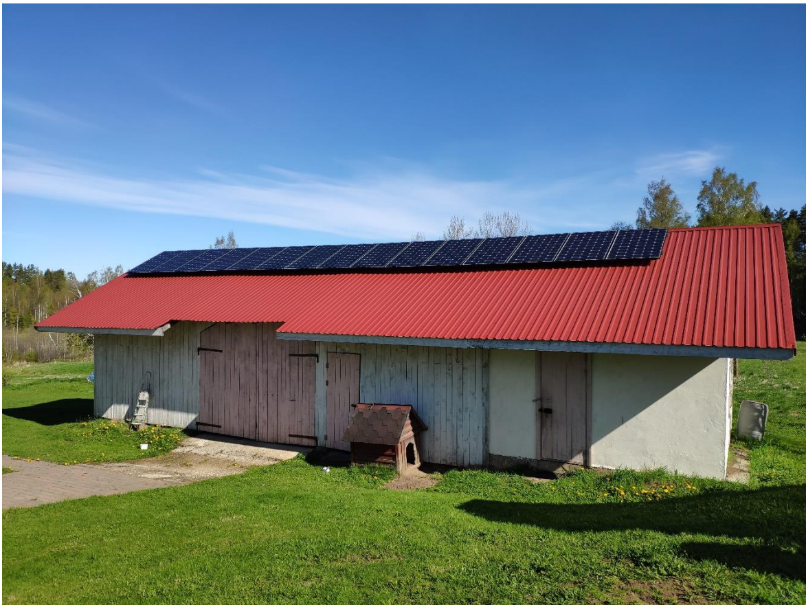
Joonis 1.2 Päikeseelektrijaam nimivõimsusega 3,3 kW
