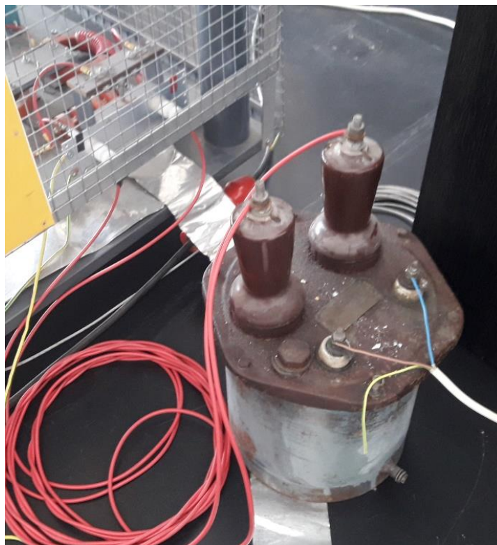
Joonis 3.2 Tesla pooli toitmiseks kasutatud 10 kV trafo
