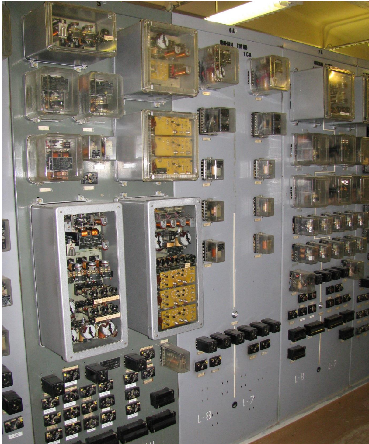
Joonis 1.1 Elektromehaanilised releed alajaamas
