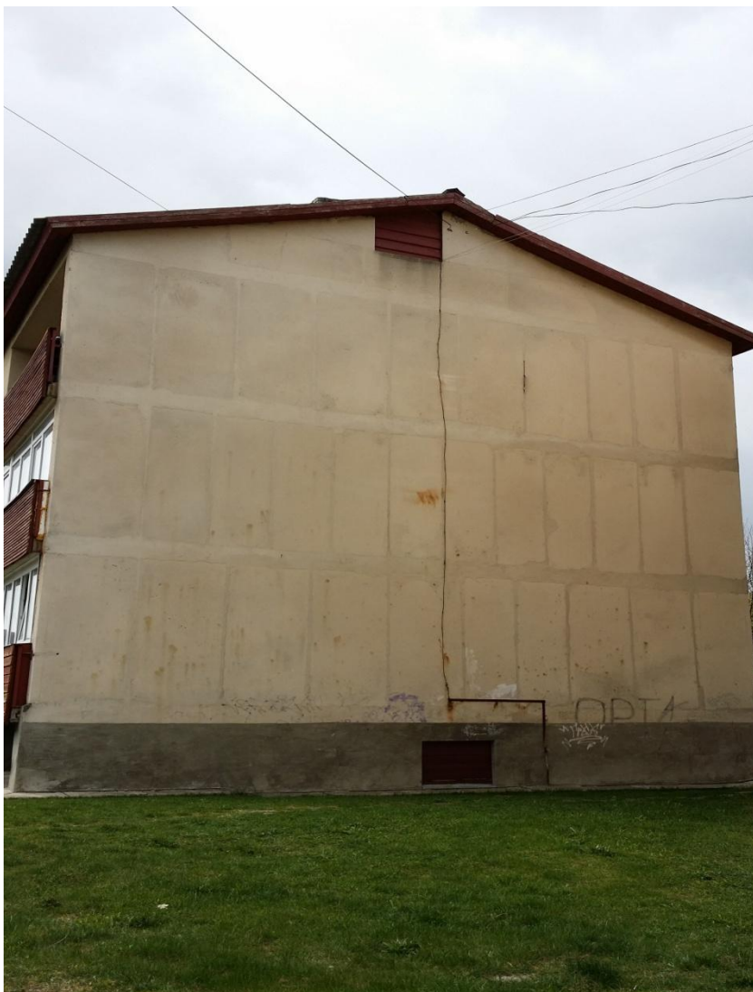
Фото №13. Дом не утеплен. Местами штукатурка подпорчена: взбучена или отпавшая.
