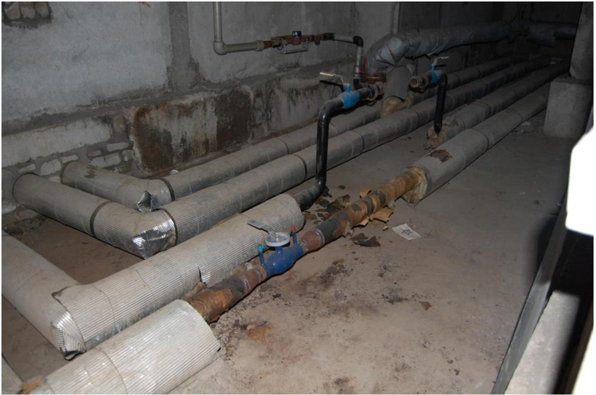
Фото №5. В фото показано, что утеплитель отопительной системы содран полностью
