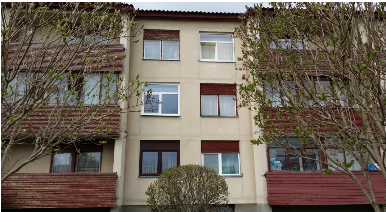
Фото №14. Облицовка лоджий нуждается в покраске, местами надо вставить новое дерево.
