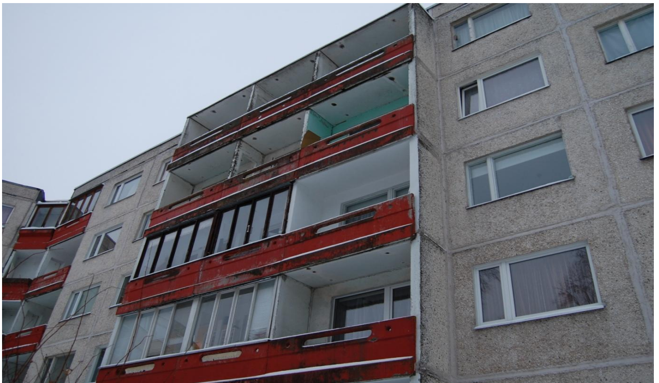
Фото №4. В фото показано, что на балконных панелях образовался органический нарост, местами панели сколоты
