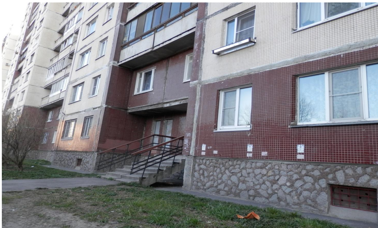
Фото №9. Дом не утеплён. Не утеплённый фундамент.
