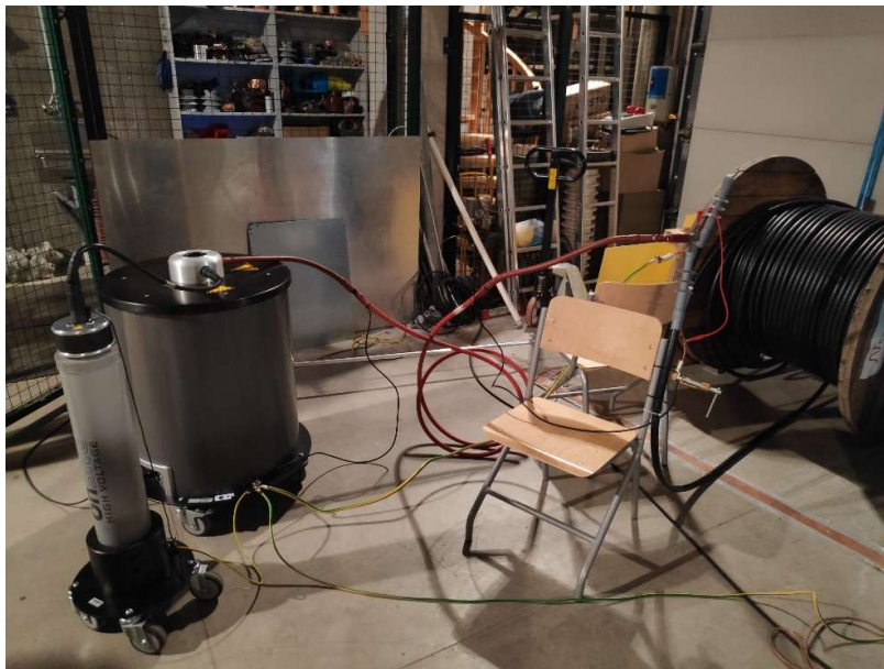
Joonis 3.4. Onsite HV DAC mõõteseadme TalTechi kõrgepingelaboris katsete teostamise ajal
