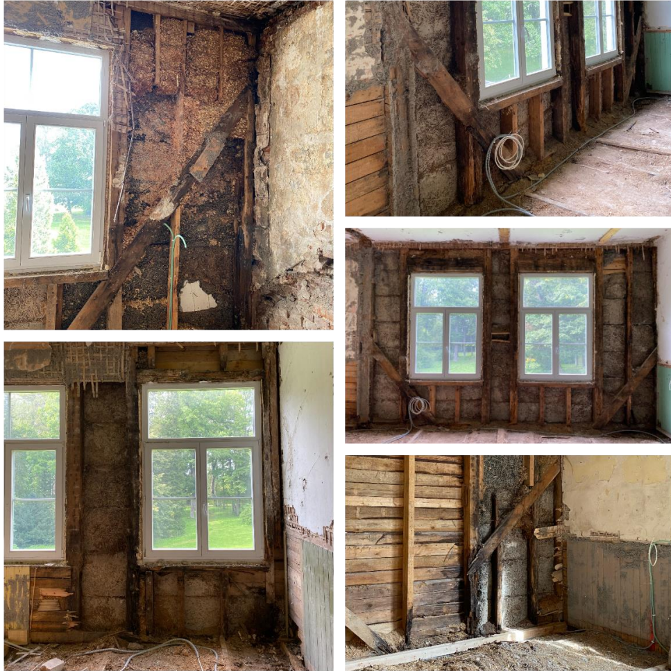
Joonis 8 – Puitkajjustused tekkinud katuse ning fassaadi veeleketest vana puitkarkassil hoone kandvates seintes – Fotod: Kristjan Karik
