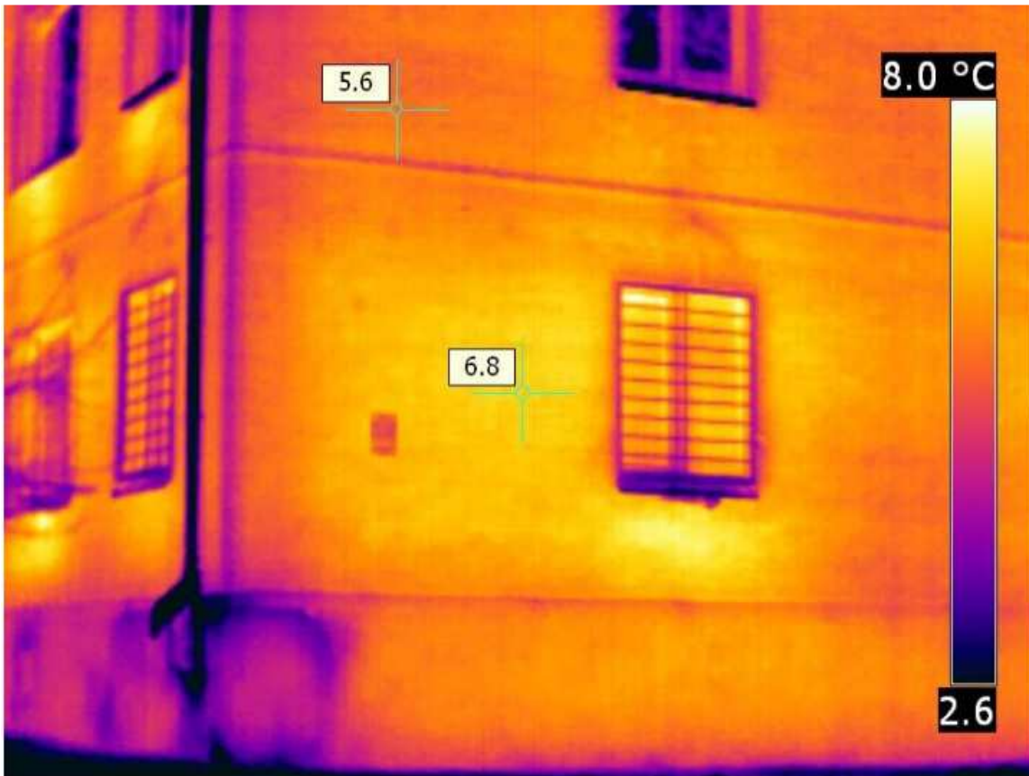
Joonis 11. Kangru 4 termofoto enne renoveerimist (5).
