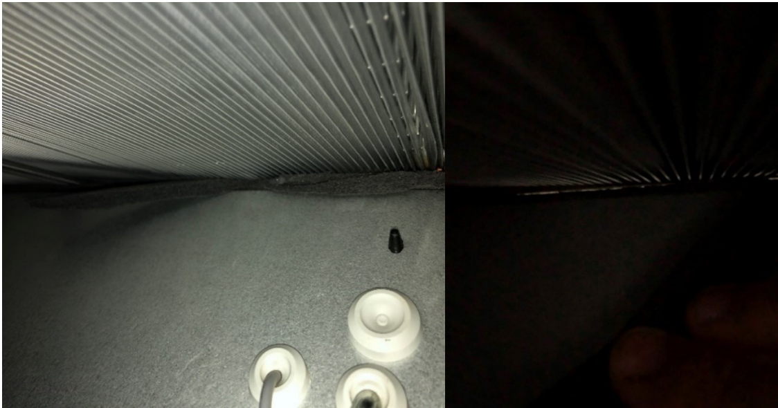
Foto 7. SV11 soojusvaheti sissepuhke ja väljatõmbe sektsiooni vaheline ebatihedus
