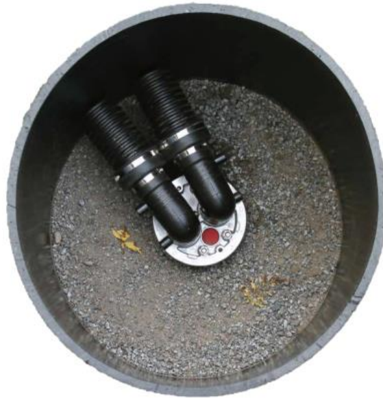
Joonis 10 Energiapuurkaevu vaatluskaev [22]
