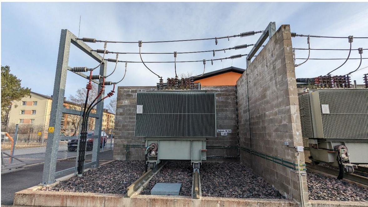
Joonis 4.6 35/2x1 kV veotrafo
