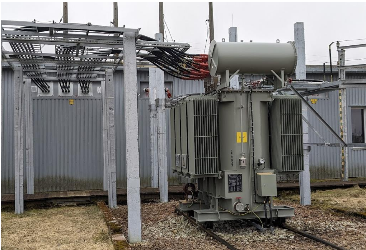
Joonis 4.14 Raasiku vealajaama veotrafo T-AA 10/3 kV
