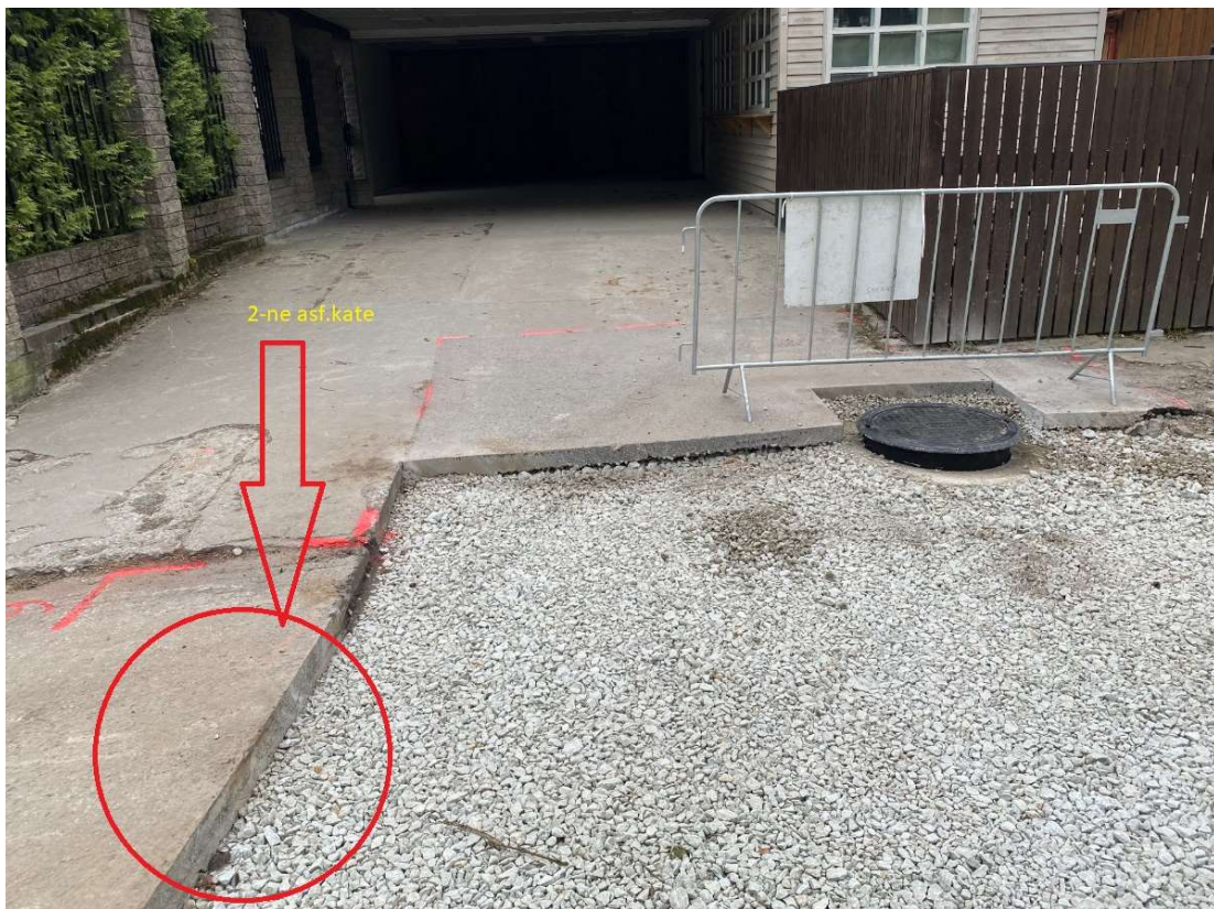
Joonis 3.4 Lauu tn lõigatud asfaldikate
